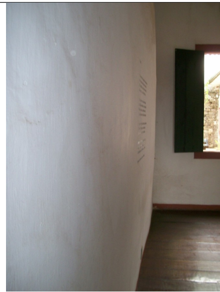
Figura 14 – Estufamento da parede.
