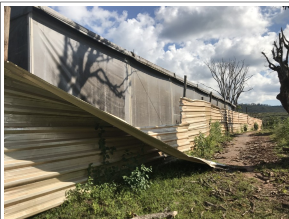
Figura 21 - Cercamento danificado no entorno da Capela de São Bento.
