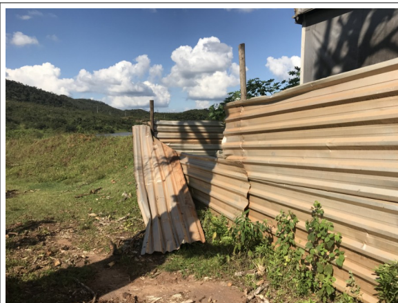
Figura 22 - Cercamento danificado no entorno da Capela de São Bento.
