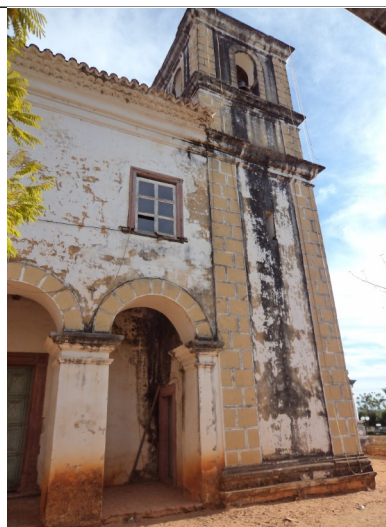
Figura 15 – Detalhe da lateral. Verifica-se que o estão é ruim. Fonte: Promotoria de Patrimônio Cultural
