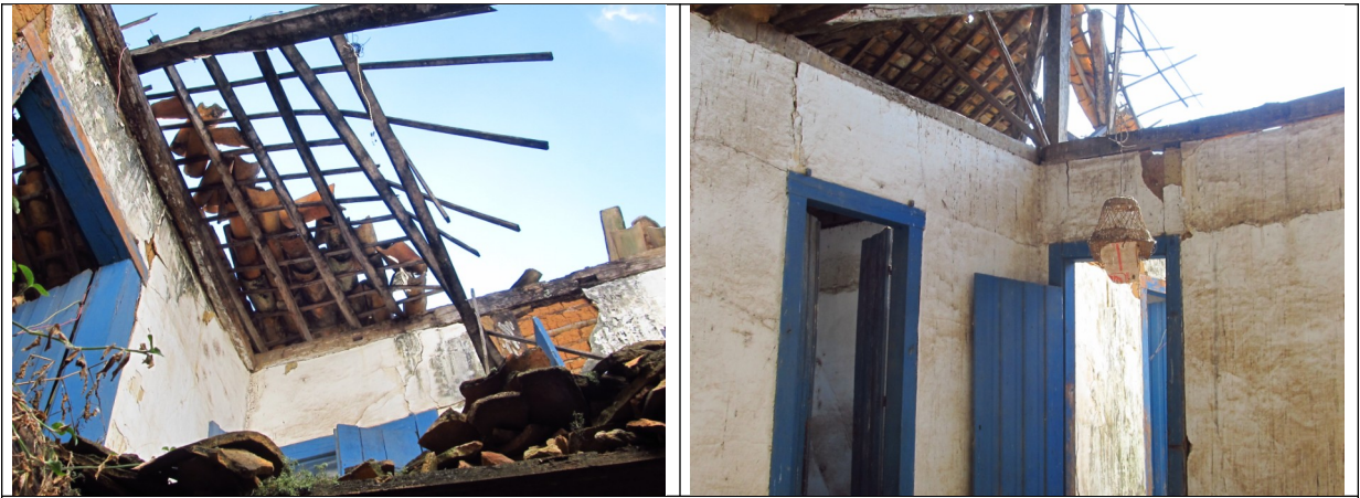
Figuras 06 e 07- Cobertura em processo de arruinação. Fotos da vistoria.
