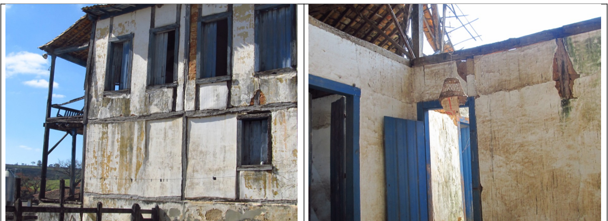
Figuras 10 e 11- Alvenarias da edificação e peças do sistema estrutural deslocadas e / ou comprometidas. Fotos da vistoria.
