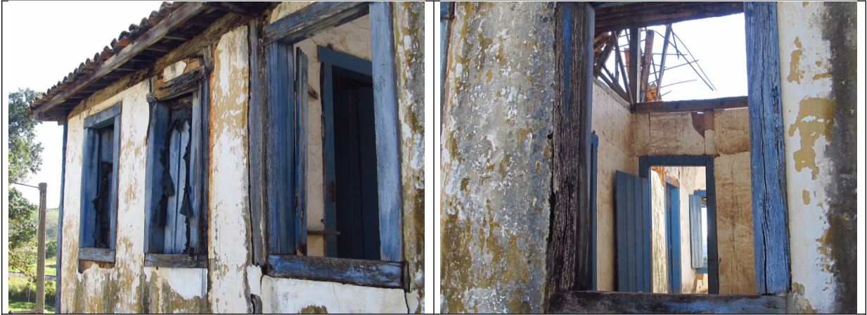
Figuras 12 e 13- Esquadrias danificadas do casarão da Fazenda Floresta em Matozinhos. Fotos da vistoria.
