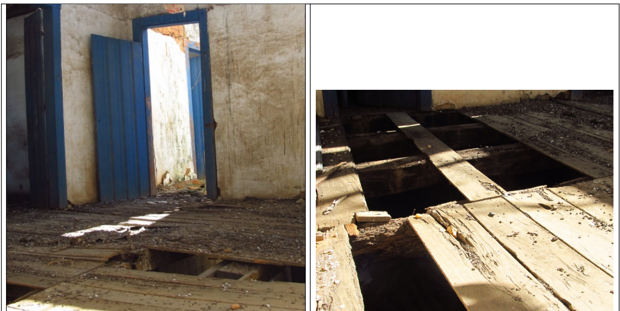
Figuras 14 e 15- Piso tabuado de madeira do casarão da Fazenda Floresta em Matozinhos. Foto da vistoria.
