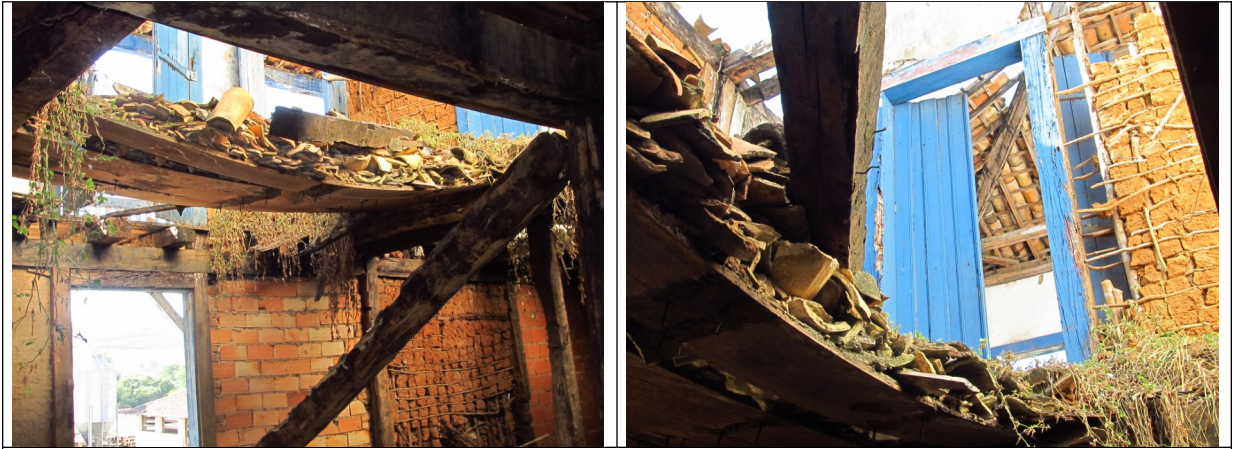
Figuras 16 e 17- Entulhos decorrentes do arruinamento do casarão da Fazenda Floresta em Matozinhos. Fotos da vistoria.
