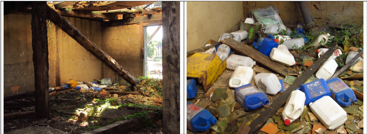
Figuras 18 e 19- Entulhos no porão do casarão da Fazenda Floresta em Matozinhos. Fotos da vistoria.
