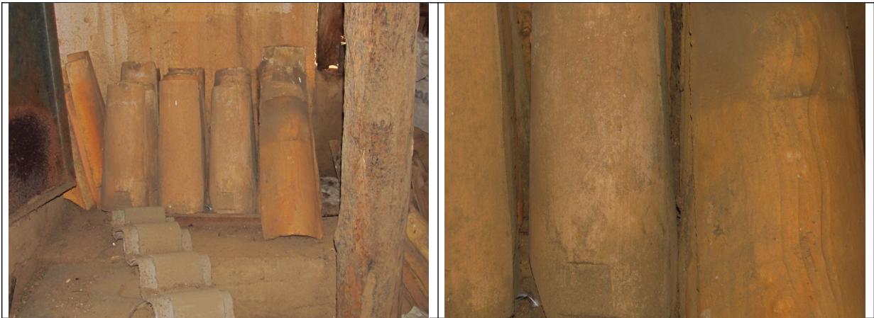
Figuras 20, 21, 22 e 23- Estrutura em pau-a-pique e telhas antigas acumulados no porão do casarão da Fazenda Floresta em Matozinhos. Foto da vistoria.
