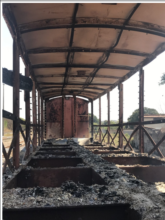
Figura 21 – Vagão recentemente incendiado.
