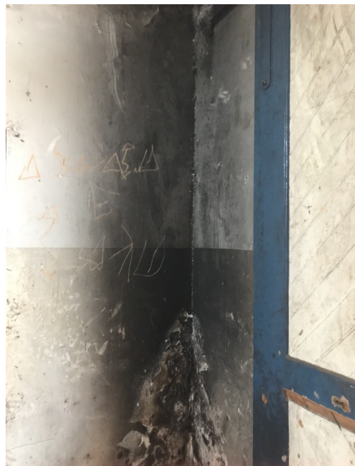
Figura 13 – Manchas de fogo nas alvenarias internas.
