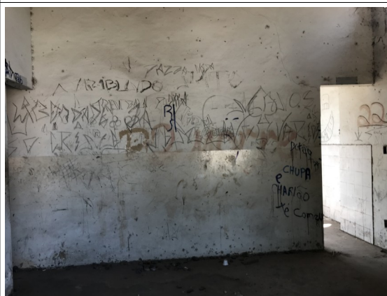
Figura 12 – Inscrições e pichações nas paredes internas da Estação.
