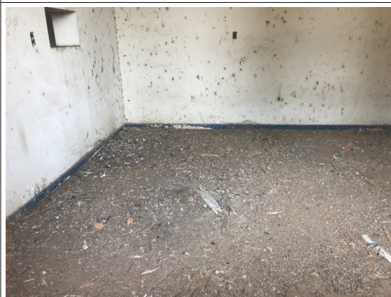
Figura 11 – Sujeira e degradação das áreas internas.
