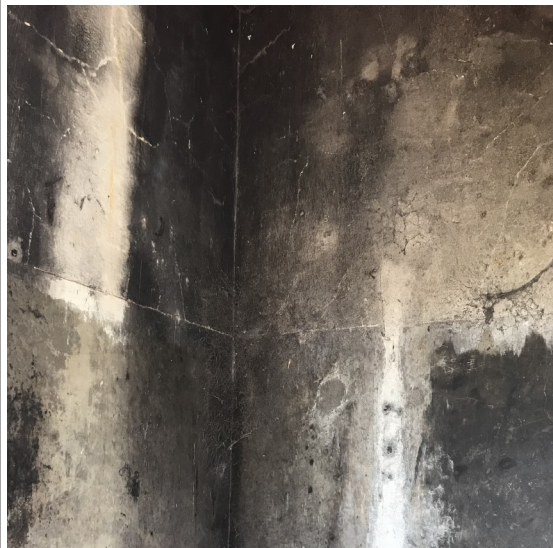
Figura 18 - Manchas de fogo na área interna.
