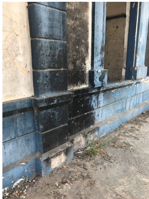
Figura 14 – Manchas de fogo nas alvenarias externas.
