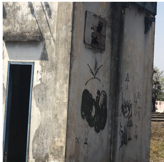
Figura 17 - Manchas de umidade e pichações.
