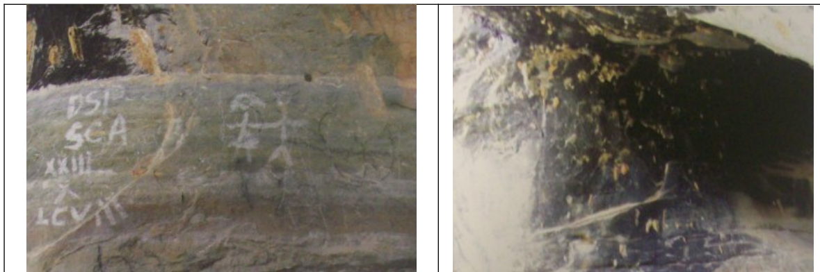
Figuras 13 e 14- Depredações e escurecimento do painel rochoso pela fuligem no MN Vargem da Pedra. Fotos constantes do Relatório de Vistoria ao Monumento Natural Vargem da Pedra, elaborado pelo Analista Ambiental e Arqueólogo, Leandro Vieira da Silva, 2014.
