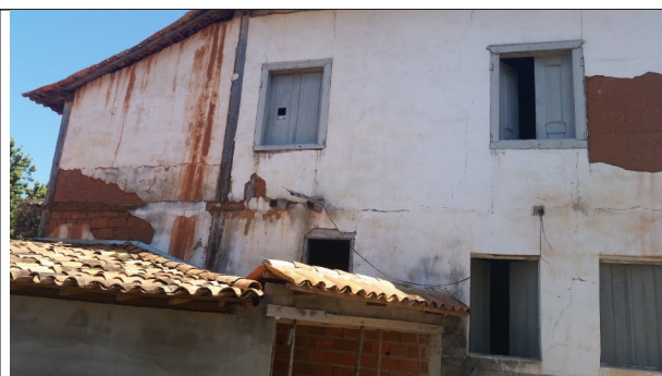
Figura 29 – Obstrução de vão e instalação de rufos em alvenaria já bastante comprometida.
