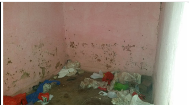
Figura 14 – Presença de lixo no interior do prédio.
