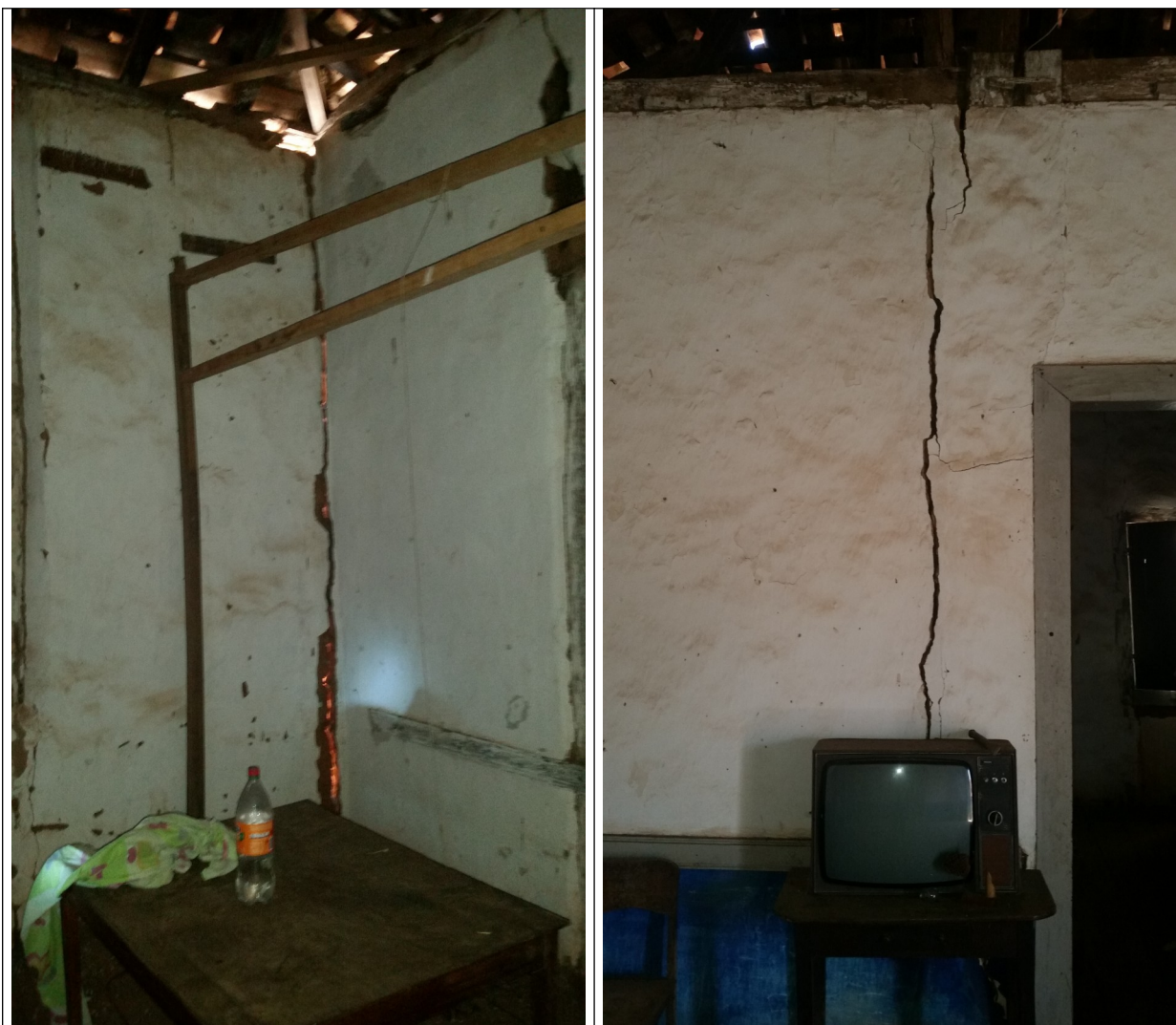
Figuras 18 e 19 – Presença de trincas profundas nas alvenarias.
