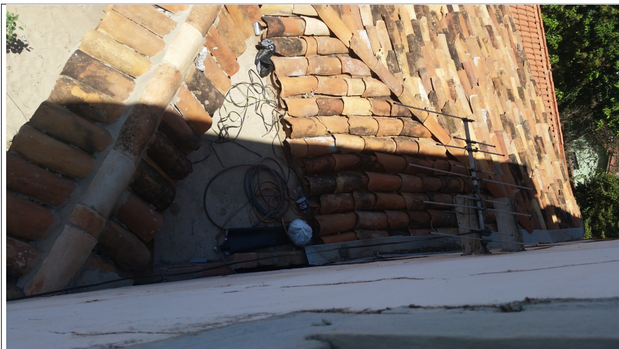
Figura 27 - Parte da cobertura da garagem em laje plana, desprovida de telhas. Neste trecho, não há calhas para drenagem da água que poderá se empoçar junto à fachada lateral do Solar da Tia Auta.
