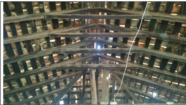
Figura 12 – Detalhe da cobertura onde se verificam várias telhas faltantes.
