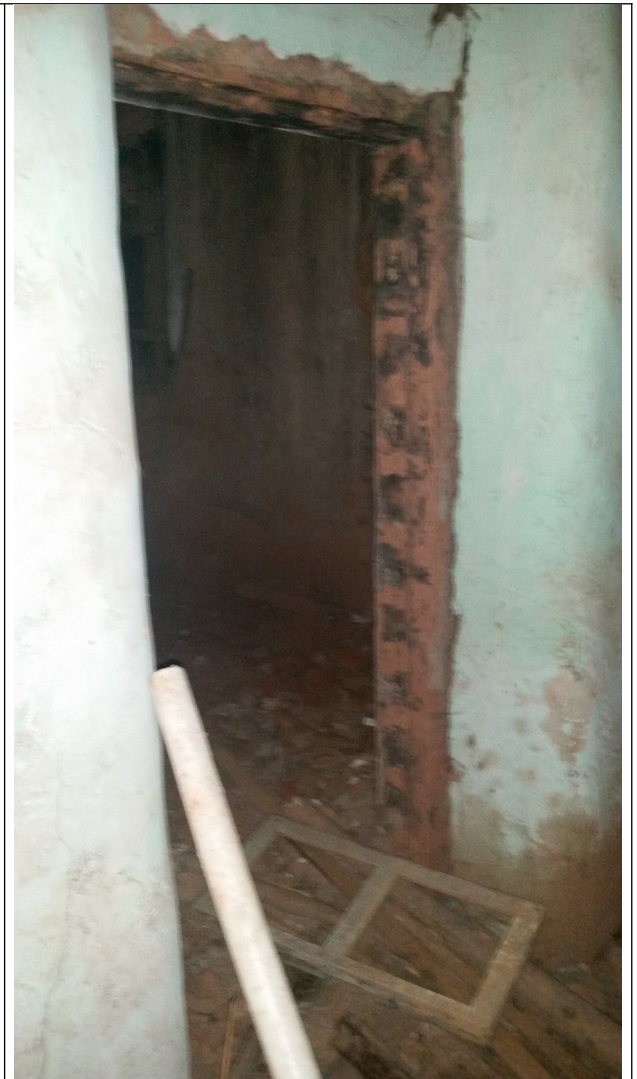
Figura 17 – Ausência de esquadrias.
