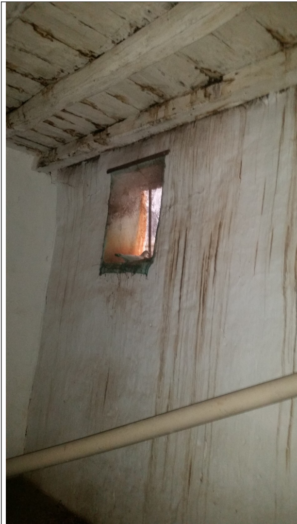
Figura 16 – Manchas de umidade nas alvenarias.
