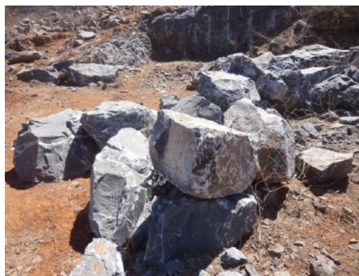
Figura 32 – Detalhe das pedras soltas.
