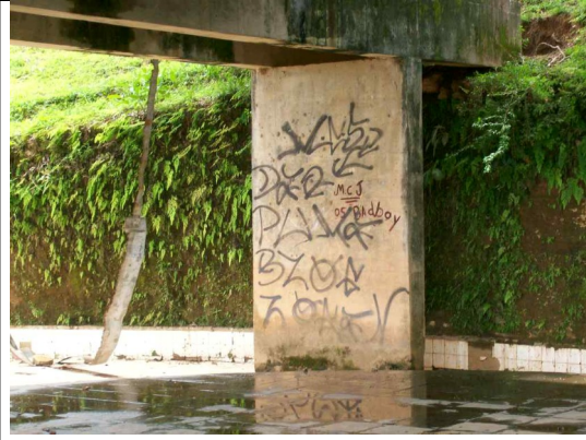
Figura 15 – pichações nos pilares
