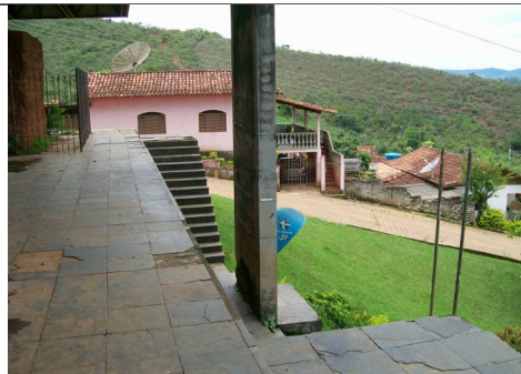
Figura 19 – falta de guarda-corpo.
