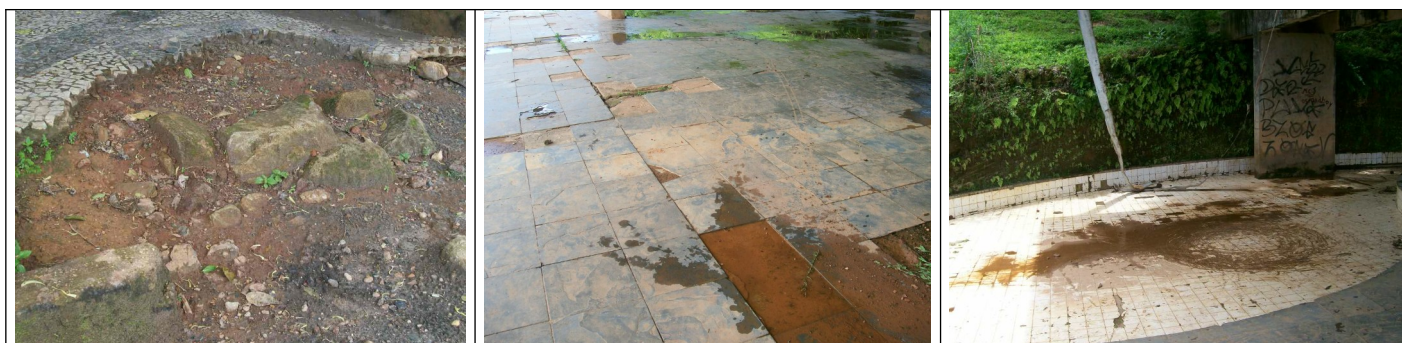
Figuras 12, 13 e 14 – revestimentos dos pisos em péssimo estado de conservação.
