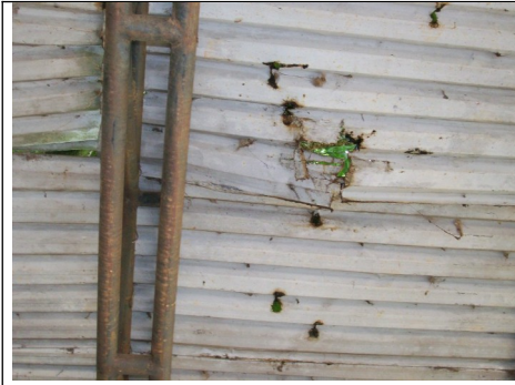
Figura 4 – cobertura com peças oxidadas e ferrugens.
