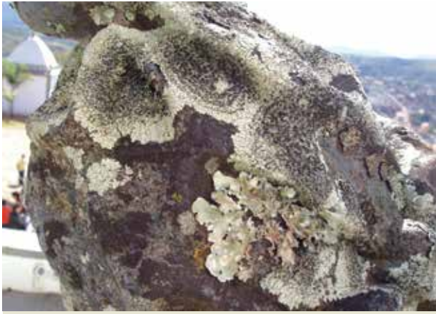
Detalhe do Profeta Jonas, infestado por líquens quando da campanha de desinfestação realizada em 2005. Acervo CETEC/MG
