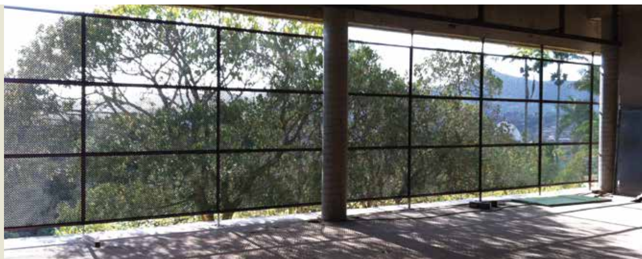
Janela lateral durante a obra, fechada por treliça metálica, antes da colocação de fechamento com vidro e filtro solar. Fotografia: Luis Sardá
