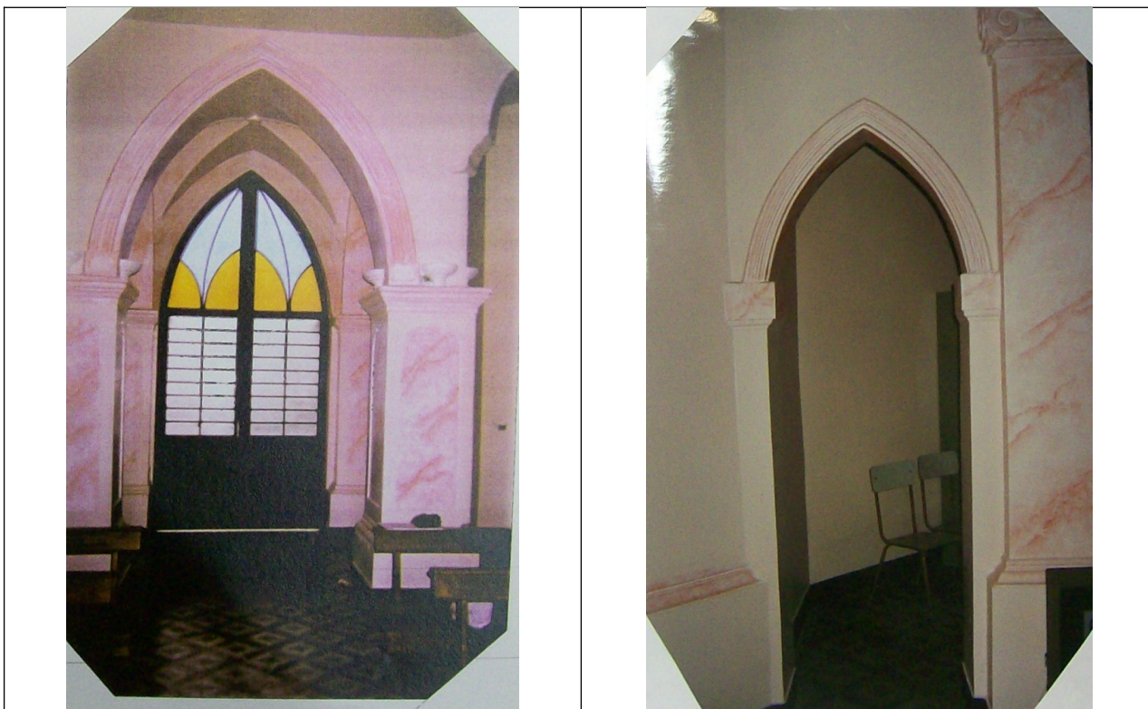
Figuras 05 e 06 – Imagens internas da igreja, onde se percebe a presença do piso em ladrilhos hidráulicos.
