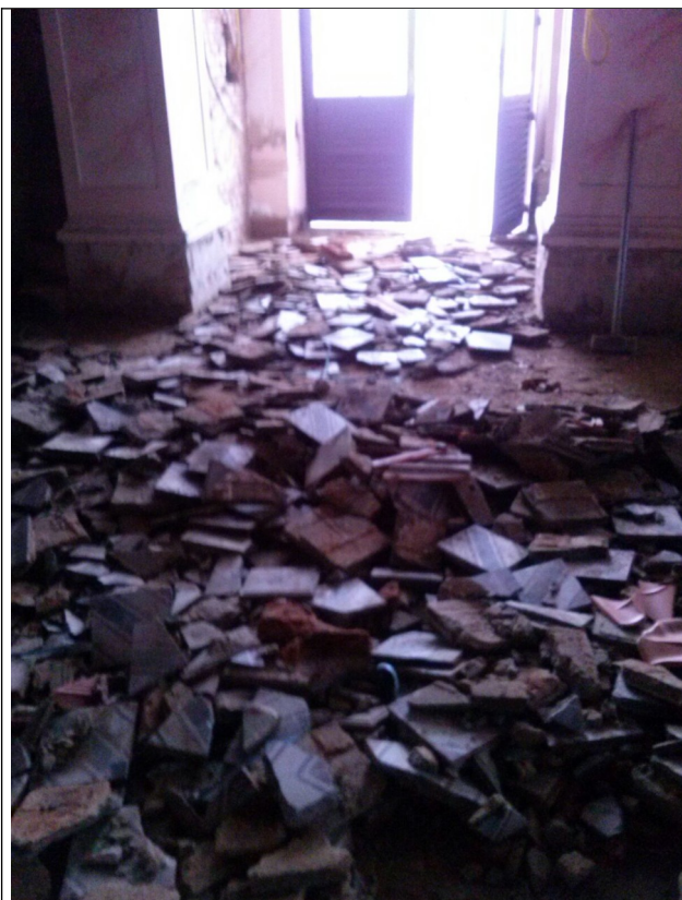
Figura 07 – Imagem da obra em andamento na igreja, que removeu grande parte do piso em ladrilhos hidráulicos.
