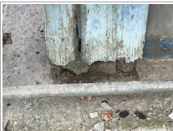
Figura 13 - Pé de esteio comprometido.
