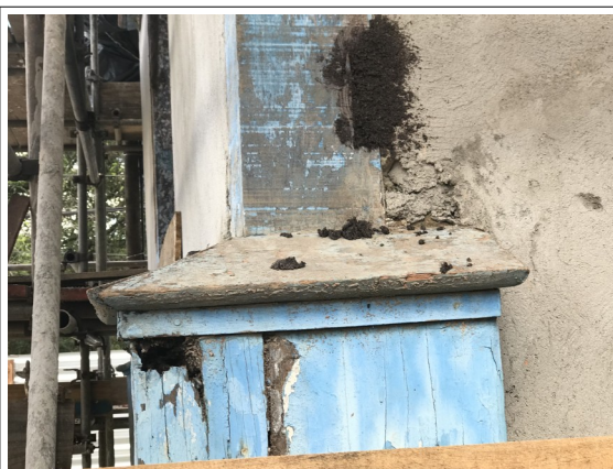
Figura 14 - Elemento de madeira comprometido (revestimento do cunhal).
