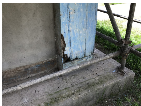
Figura 16 - Elemento de madeira comprometido (revestimento do cunhal).
