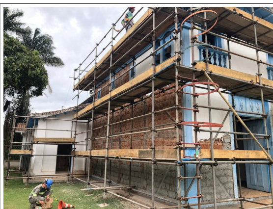
Figura 02 - Imagem integrante da certidão, com emboço e reboco em fase de execução.
