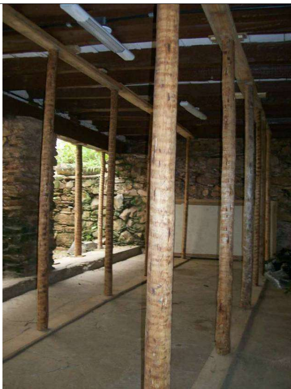
Figura 10 – Esquema para escoramento das peças de madeira do telhado, do piso (através do porão) e das varandas.
