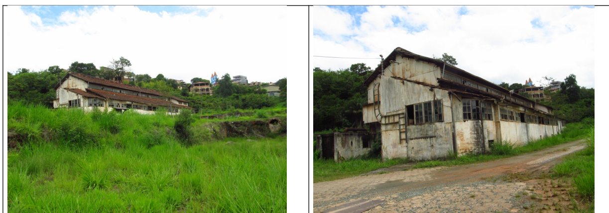
Figuras 26 e 27- Oficina Elétrica, integrante do antigo complexo de Morro Velho. Fotos da vistoria.
