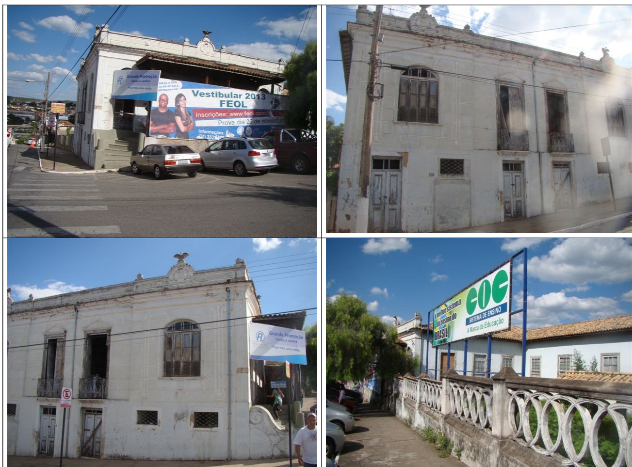
Figuras 03 a 06 – Imagens do estado de conservação da edificação e dos engenhos de publicidade presentes.
