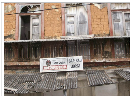
Figura 12 – Descaracterização na fachada do imóvel.
