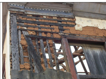
Figura 13 – Alvenaria de pau a pique deteriorada.
