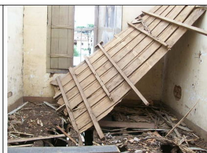
Figura 17 – Forro que cedeu.
