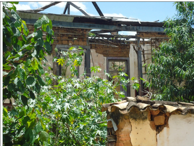
Figura 10 – Arruinamento de paredes de vedação em 03/02/2012.
