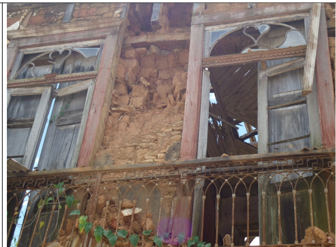
Figura 11 – Desprendimento do sistema construtivo de terra em 03/02/2012.
