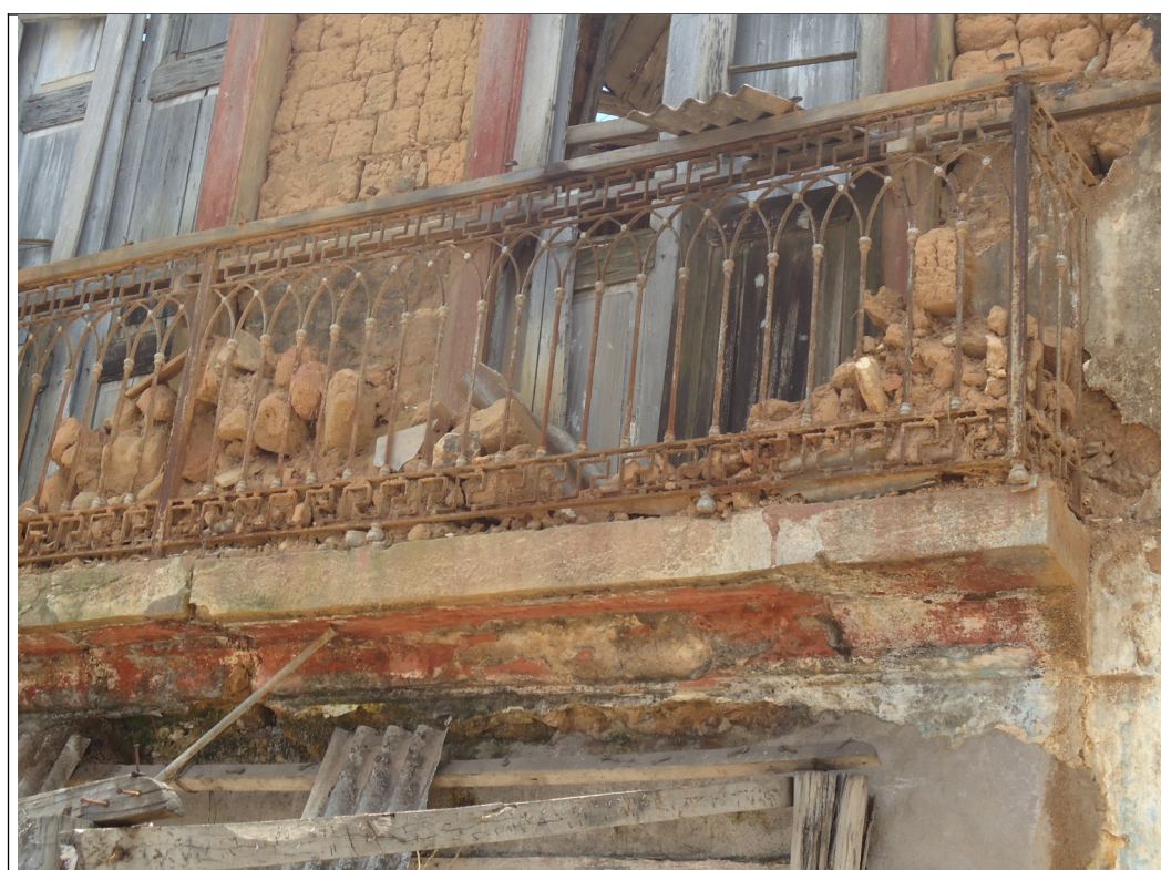
Figura 09 – Desprendimento do barro da trama de pau a pique em 03/02/2012.
