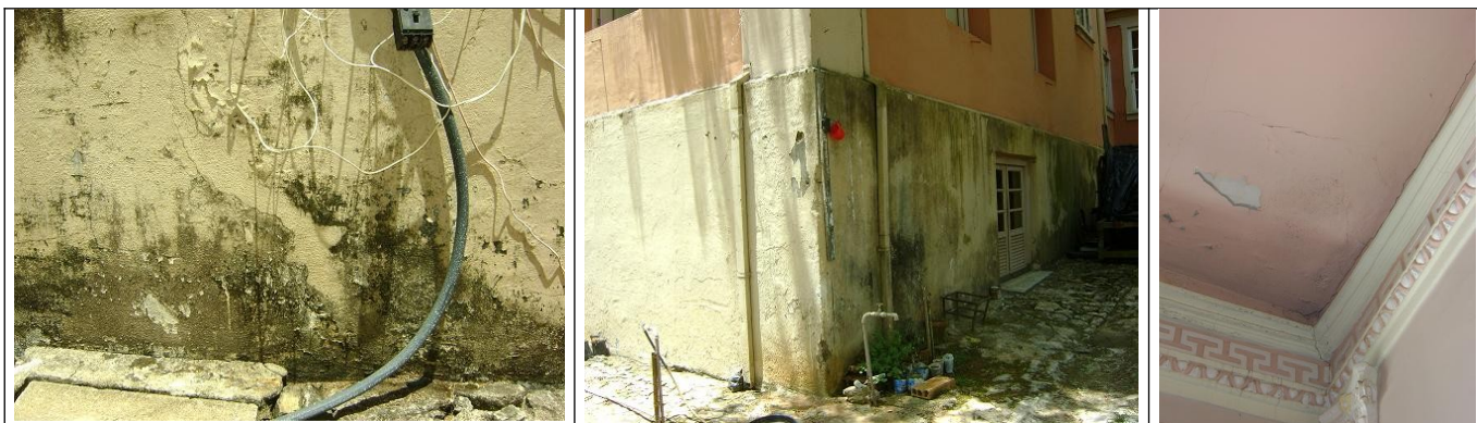
Figuras 18 e 19 – Manchas de umidade
