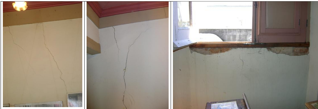
Figuras 15, 16 e 17 – Trincas, descolamento de reboco e pintura.
