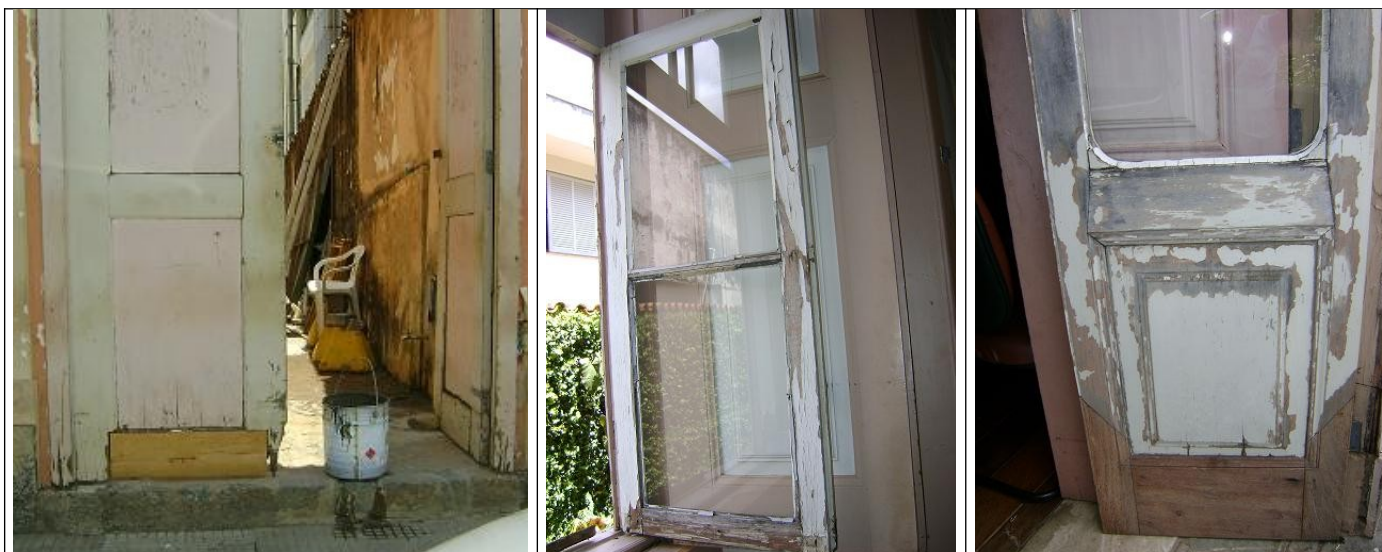
Figuras 21, 22 e 23 – Esquadrias danificadas.
