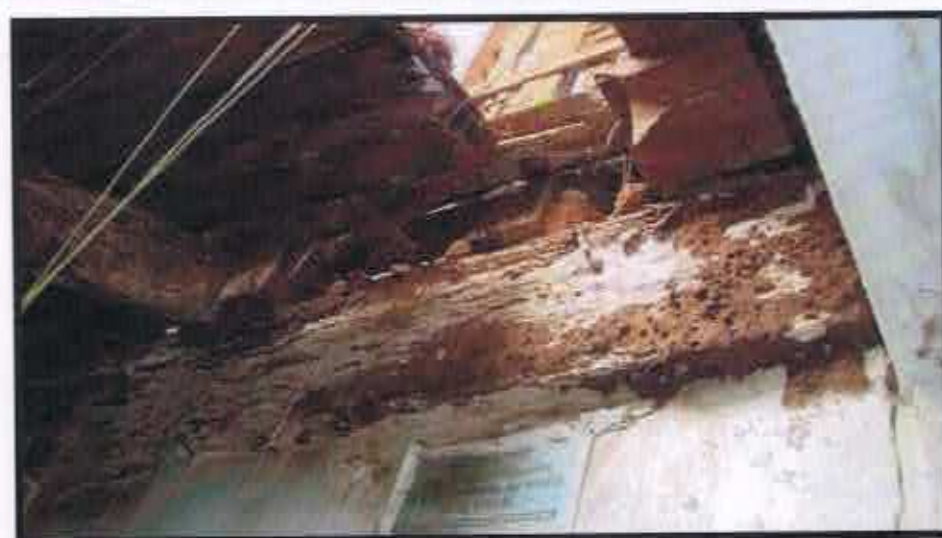
– Estrutura dos barrotes que sustentavam o piso das salas frontais. Peças comprometidas pelo apodrecimento e ataque de insetos térmitas - 07/06/2013
