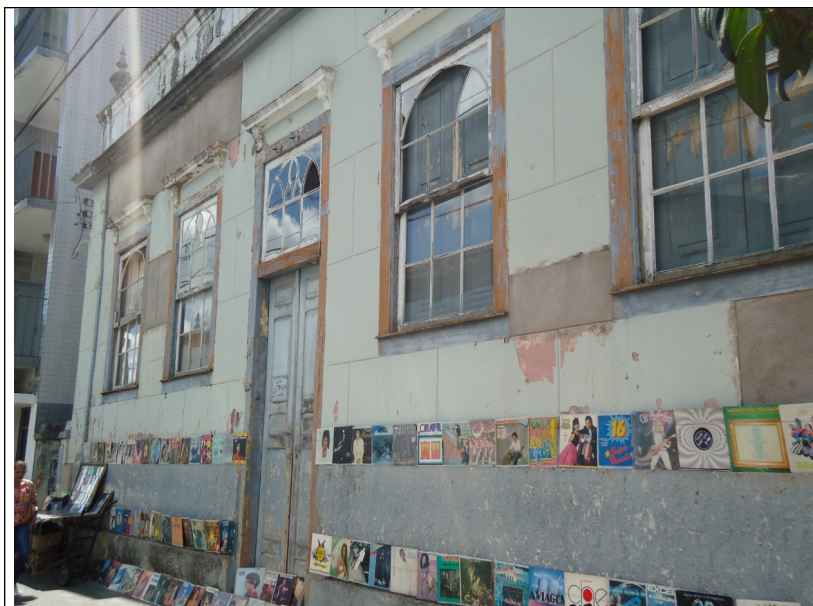
Figura 03 – Fachada frontal com emendas na alvenaria, vidros faltantes nas esquadrias e sendo utilizada por ambulante para exposição dos seus produtos.
