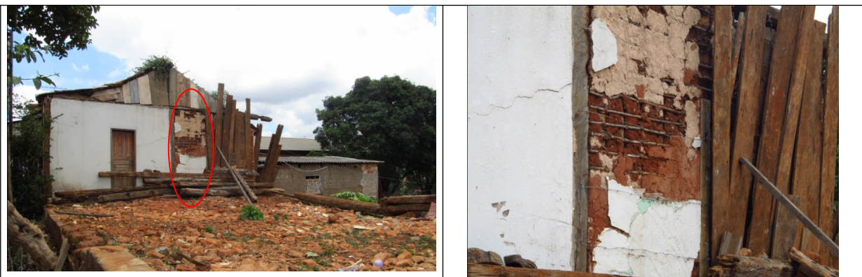
Figuras 12 e 13 – Detalhe da técnica construtiva utilizada no imóvel demolido da Rua Santo Antônio, nº 220. A 2ª imagem mostra detalhe da parede assinalada de vermelho na 1ª. Foto da vistoria.
