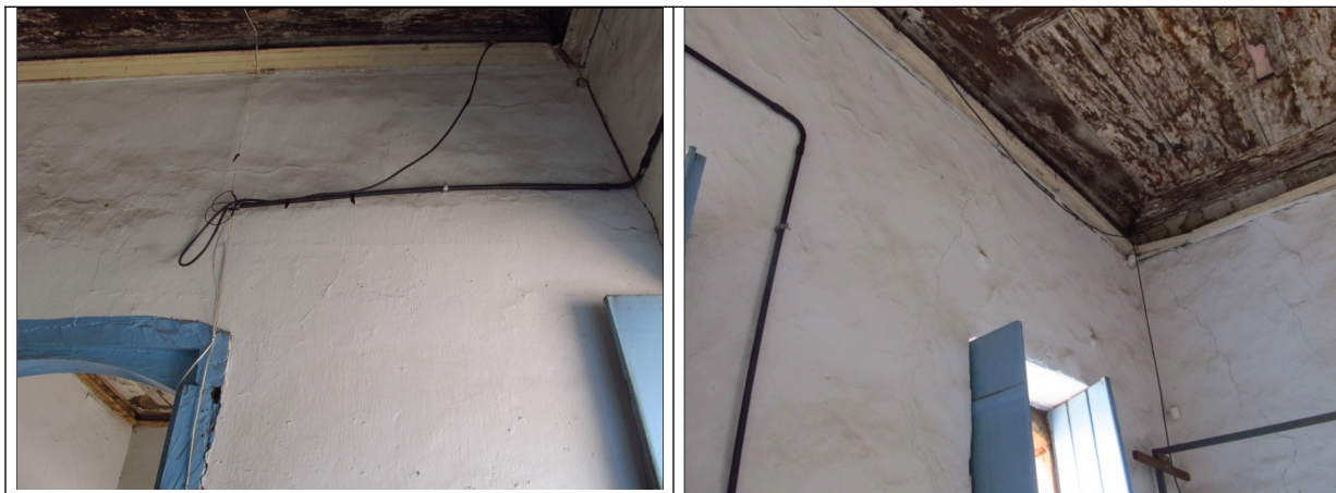
Figura 24 e 25- Fios soltos na Antiga Casa Paroquial. Foto da vistoria.
