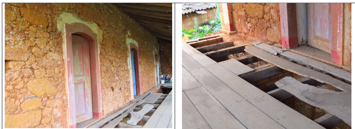
Figuras 30 e 31- Piso de madeira comprometido e parede sem reboco. Foto da vistoria.
