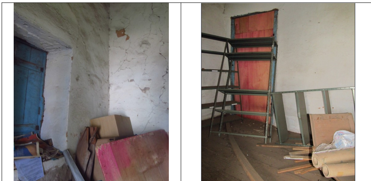
Figuras 26 e 27 - Material acumulado no interior da Antiga Casa Paroquial. Foto da vistoria.
