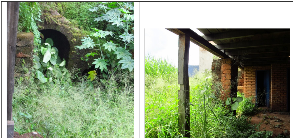
Figuras 28 e 29- Alicerces de estruturas já demolidas nos fundos da Antiga Casa Paroquial. Presença de vegetação crescida e marcas de umidade. Foto da vistoria.
