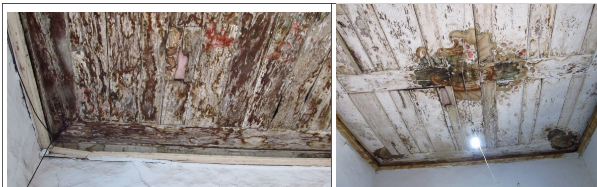
Figuras 16 e 17 - Forros da Antiga Casa Paroquial. Foto da vistoria.
