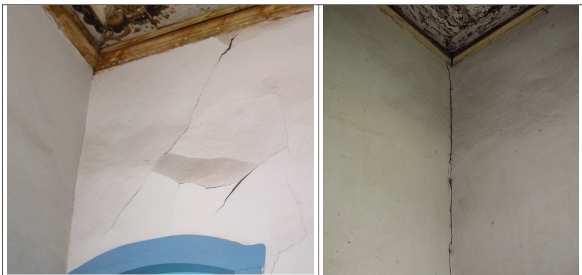
Figura 14 – Estufamento do reboco.
