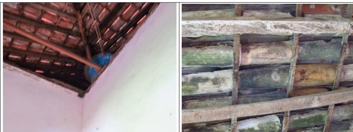
Figura 18 – Ausência de forro.
