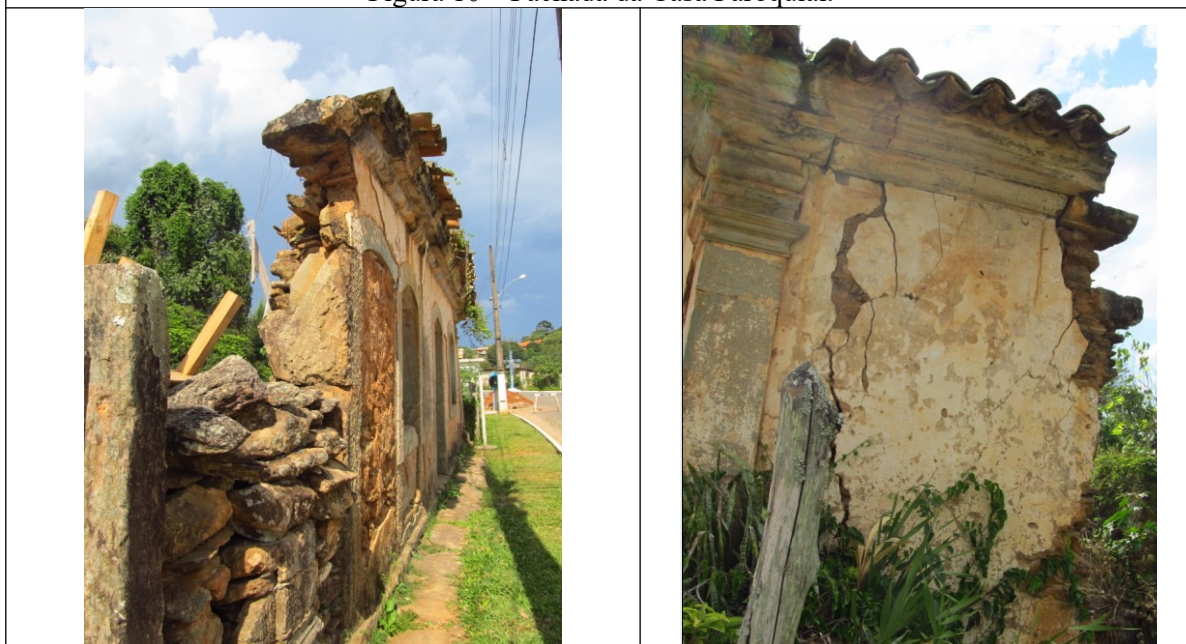
Figuras 11 e 12- Ruínas da Casa Paroquial no povoado de Itatiaia. Foto da vistoria.
