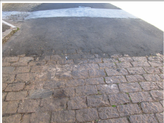
Figura 06 - Trecho com asfaltamento sobre os paralelepípedos.
