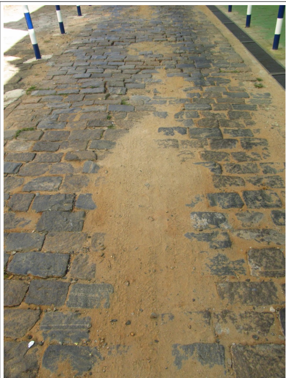
Figura 04 - Desnívelamento e acúmulo de sujeira.
