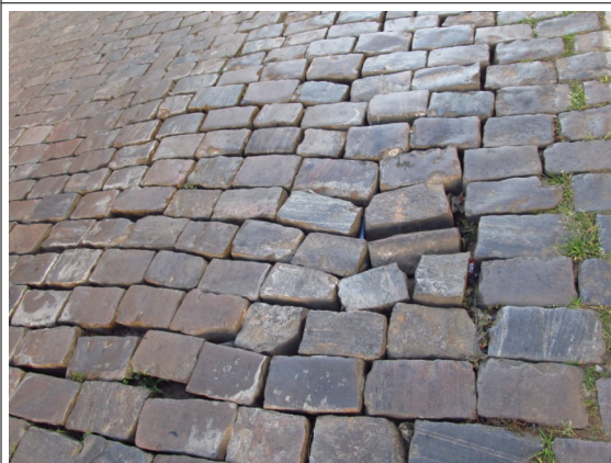
Figura 05 - Pedras deslocadas devido a má compactação.
