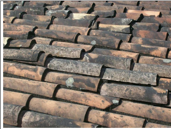
Figura 17 – Telhas com embocamento.
