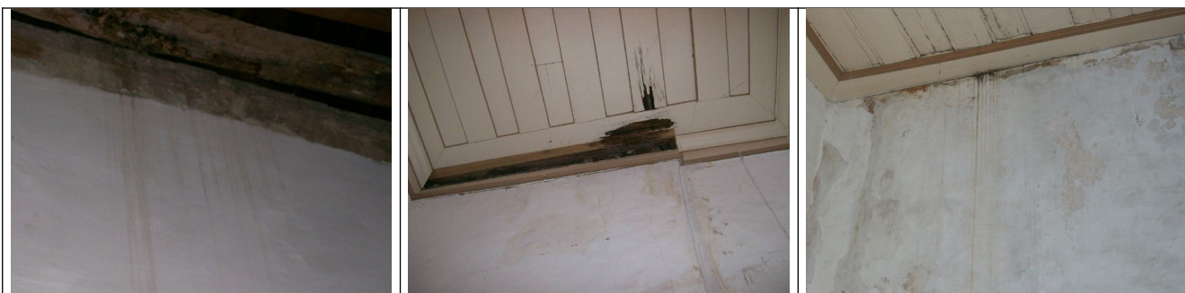
Figuras 05, 06 e 07 – Manchas de infiltrações e comprometimentos nos forros.
