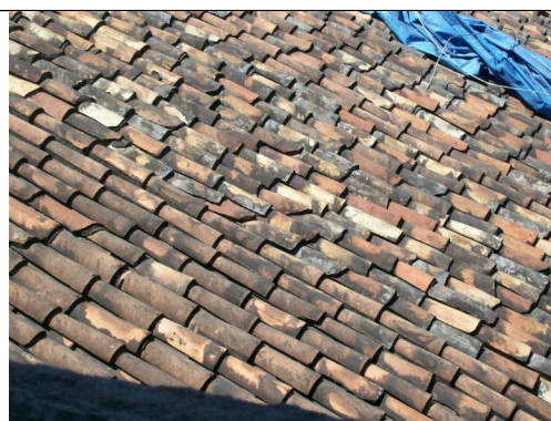
Figura 15 – Vista do telhado, com diversidade de telhas. No alto da fotografia à direita, telhas antigas. No lado esquerdo, telhas novas envelhecidas.
