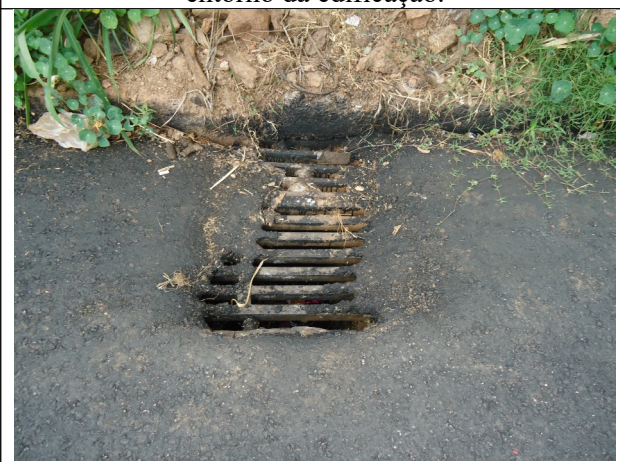
Figura 25 – Grelha do bueiro parcialmente obstruída pelo asfalto.
