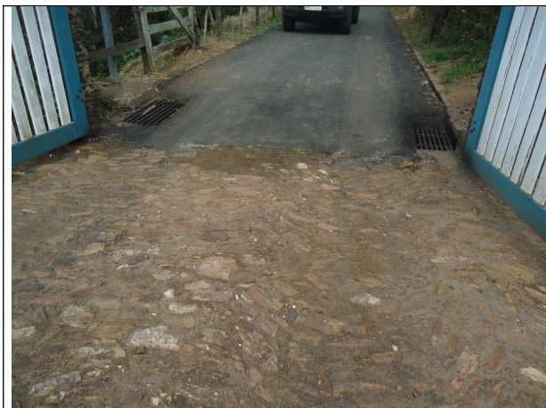
Figura 22 – Encontro do asfalto com o antigo calçamento.
