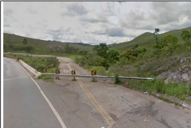
Figura 17 - Desvio e impedimento do tráfego sob o conjunto foi feito com guard-rail que não se integra à paisagem existente
