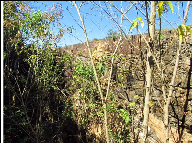
Figura 11 - Vegetação que nasce nos interstícios da estrutura da Ponte Rancharia 1.
