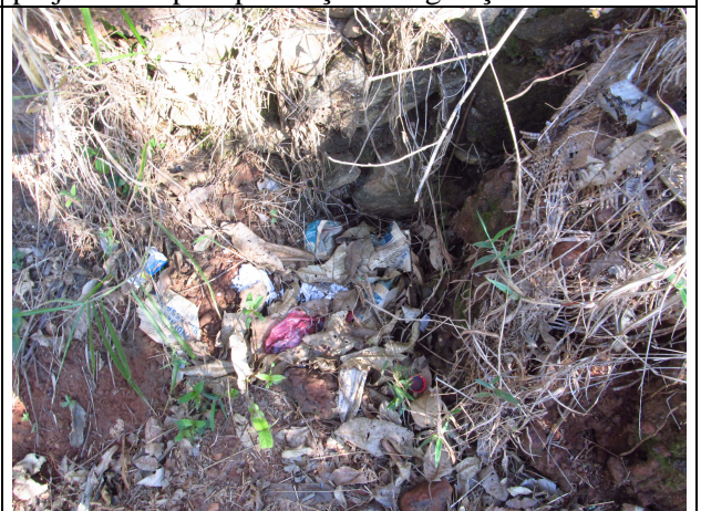
Figura 14 - Acúmulo de lixo no trecho superior e inferior das estruturas.
