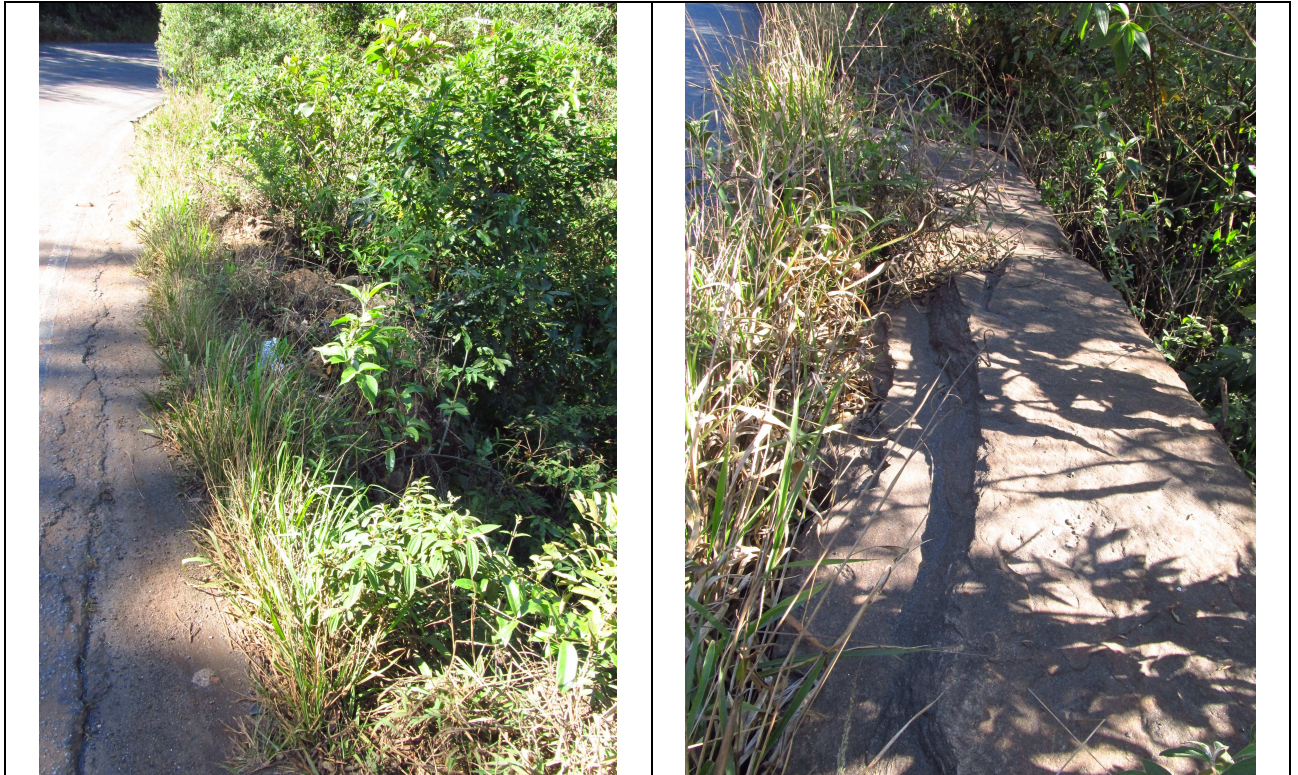
Figuras 05 e 06 – Imagem da estrutura encoberta pelo mato.
