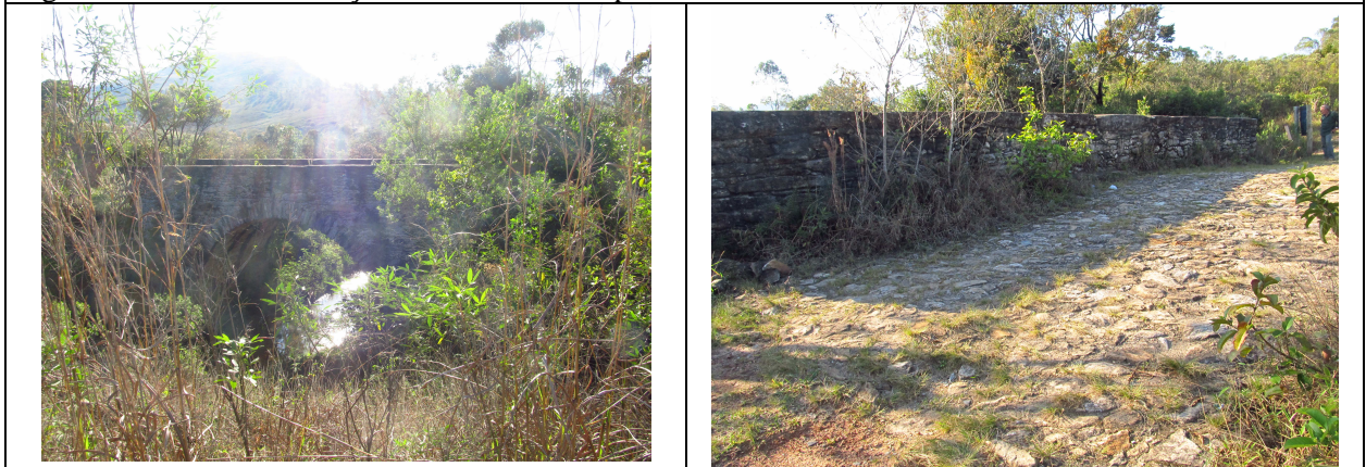
Figuras 25 e 26 – Presença de vegetação na estrutura e no entorno e danos na pavimentação.
