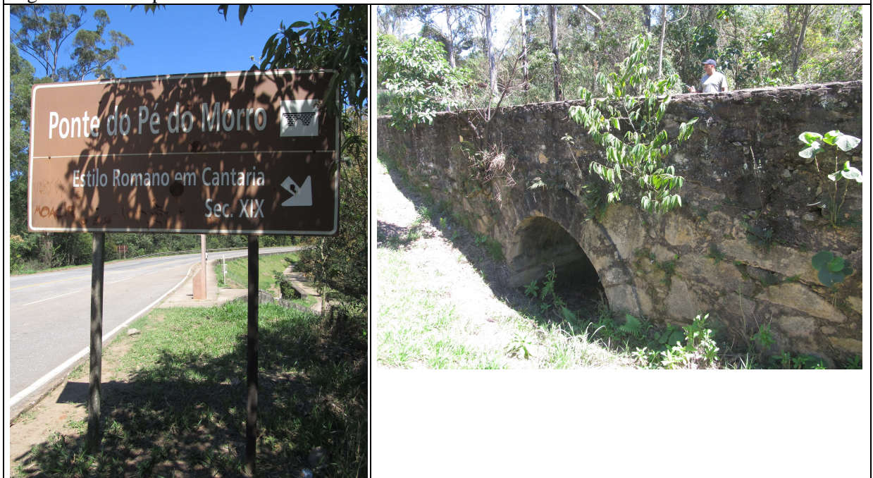
Figuras 42 e 43 – Sinalização indicativa da Ponte do Pé do Morro e detalhe da estrutura na 2ª imagem.
