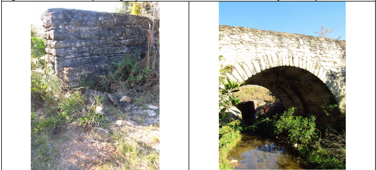
Figuras 27 – Presença de vegetação na estrutura e danos na pavimentação.
