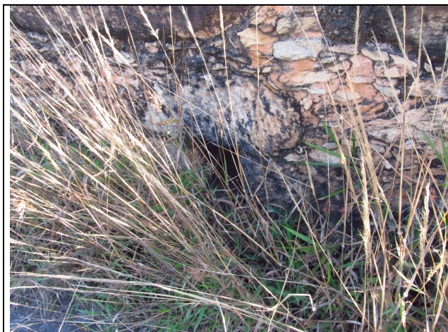
Figura 21 - Os drenos com eficácia prejudicada pela presença de vegetação.
