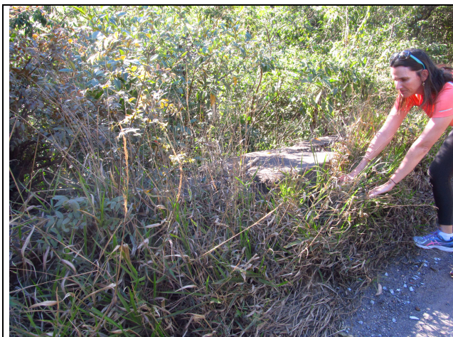
Figura 03 – Imagem da estrutura encoberta pelo mato.
