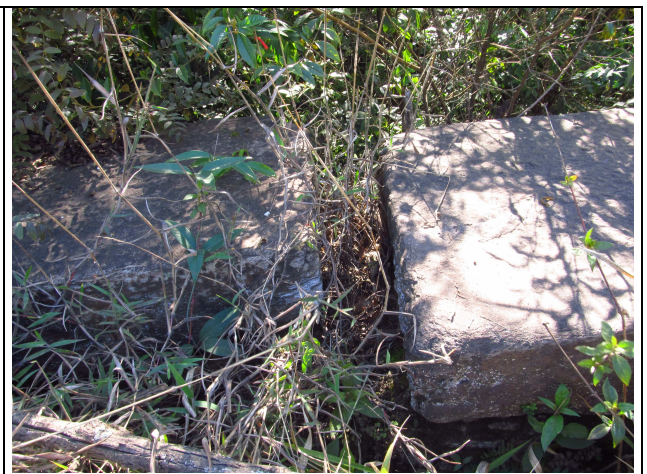
Figura 04 – Deslocamento das pedras integrantes da estrutura.
