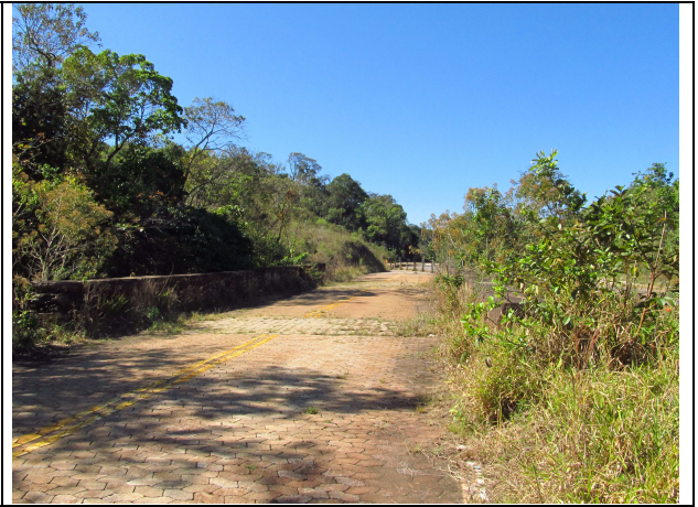
Figura 10 - Danos, desnivelamentos, vegetação invasora e falhas na pavimentação em piso intertravado de concreto.
