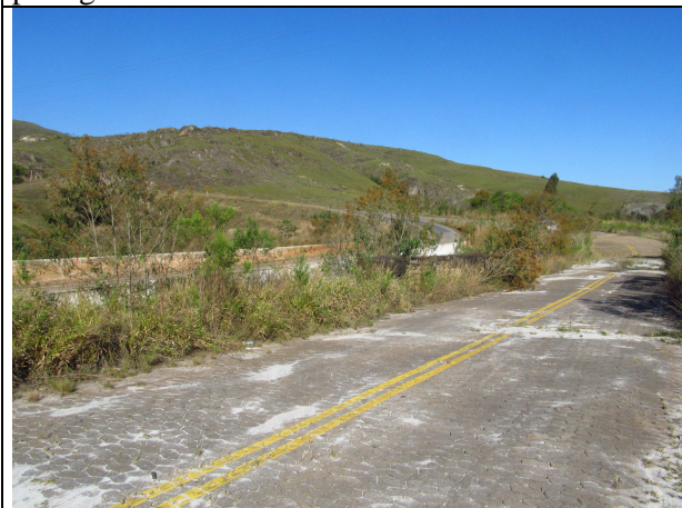
Figura 19 – Danos, desnivelamentos, vegetação invasora e falhas na pavimentação em piso intertravado de concreto.
