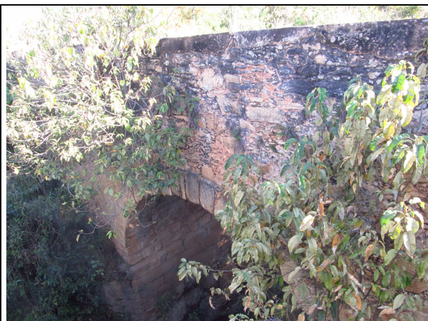
Figura 22 - Vegetação que nasce nos interstícios da estrutura da Ponte do Falcão.
