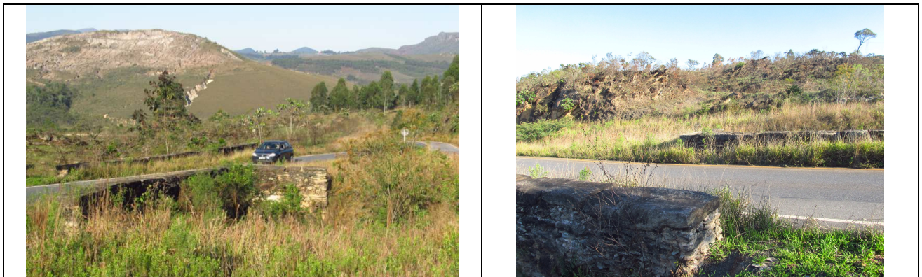
Figuras 29 e 30 – Imagens gerais da Galeria de Drenagem – Bueiro de Itatiaia. Na primeira imagem, um veículo trafegando entre as estruturas arqueológicas.
