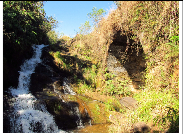
Figura 16 - Vegetação que nasce nos interstícios da estrutura da Ponte Rancharia 2.
