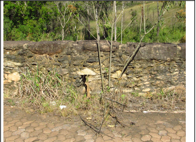
Figura 12 - Os drenos existentes tem a sua eficácia prejudicada pela presença de vegetação.
