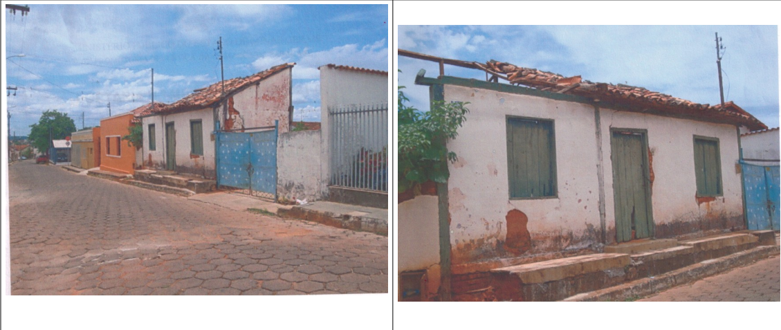
Figuras 1 e 2- Imóvel da Rua Pinheiro Chagas, nº 307. Imagens constantes dos autos.
