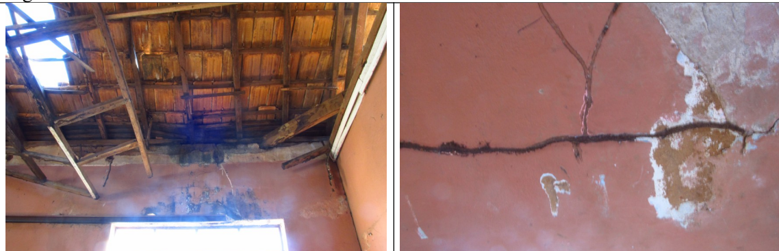
Figuras 11 e 12 – Frechal interrompido e galeria de cupins.
