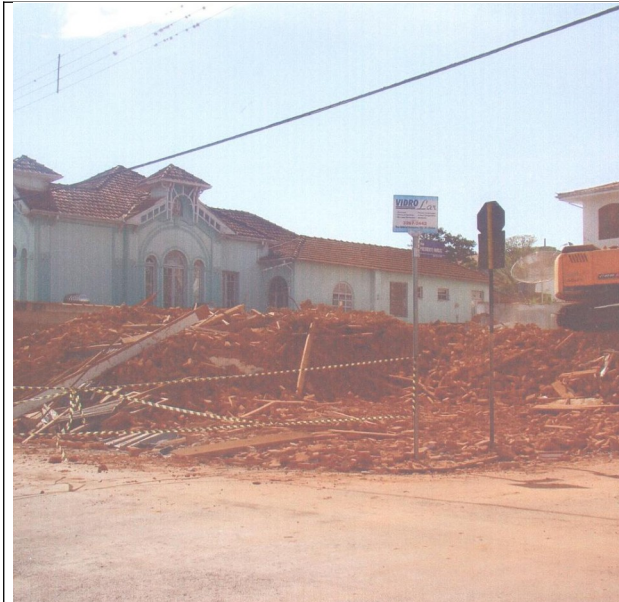
Figura 12 – Acima imagem da demolição do imóvel. Fonte: Promotoria de Justiça de Paraguaçu
