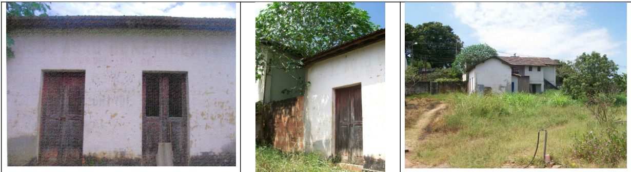
Figuras 25, 26 e 27 – Casa do Açougue encontra-se sem uso. Podemos observar há necessidade de intervenções de conservação para a proteção do bem cultural, muito mato e desgastes na edificação.
