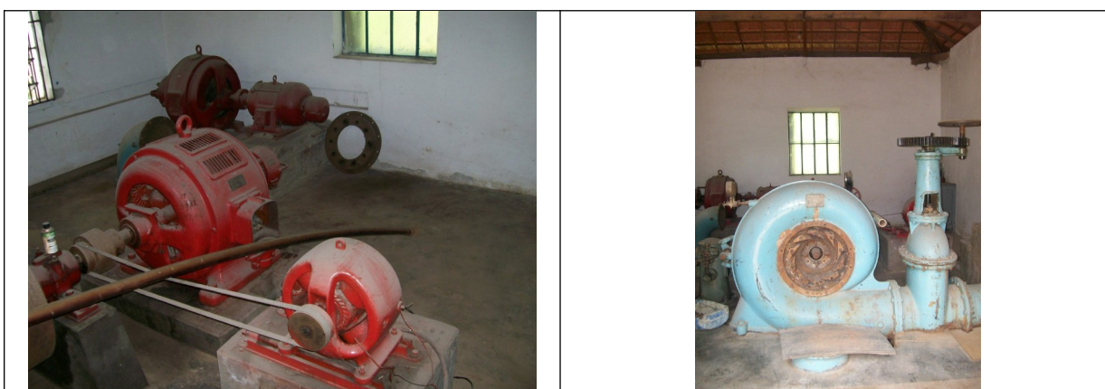
Figuras 23 e 24– Os maquinários existentes dentro da Casa de Máquinas, encontram-se em desuso.
