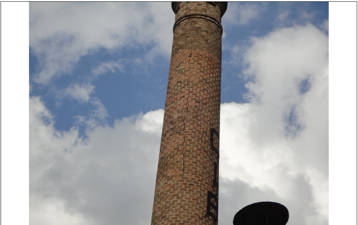
Figura 05 – Imagem representando a trinca relatada na vistoria realizada pelo Setor de Divisão de Planejamento Urbano de Obras Públicas do Município de Pedro Leopoldo.
