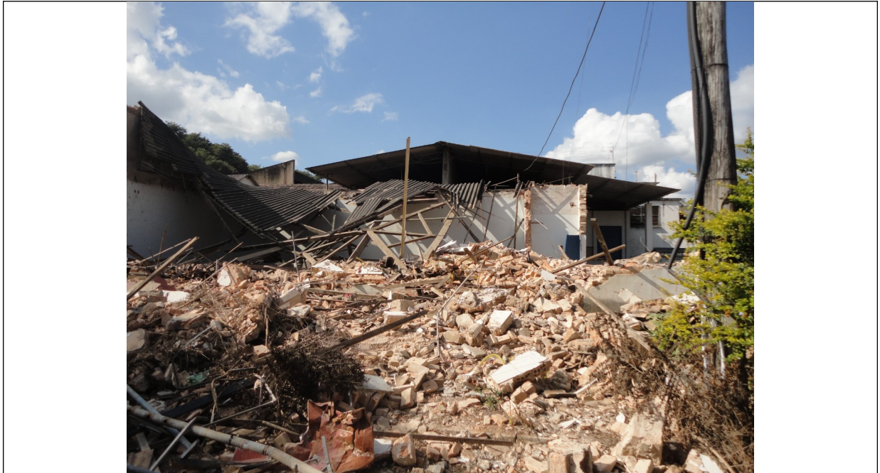
Figura 03 – Imagem com as intervenções (demolição dos galpões) ocorridas no dia 04 de abril de 2011.
