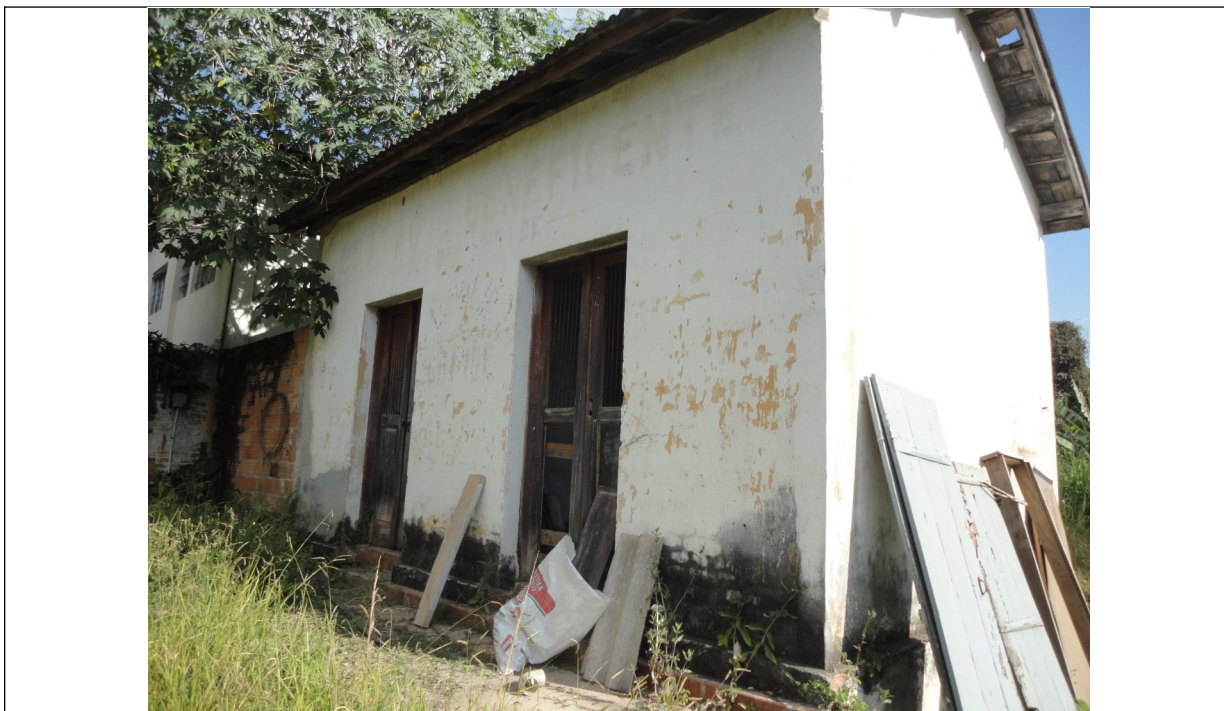
Figura 06 – Imagem do imóvel tombado (Casa do Açougue), o qual sofreu intervenções na porta, proveniente de arrombamento, os danos foram nas portas do referido imóvel.
