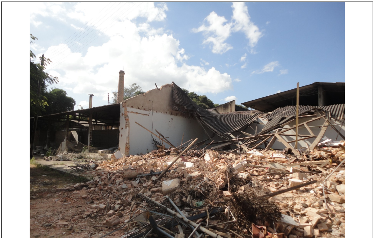
Figura 04 – Imagem com as intervenções (demolição dos galpões) ocorridas no dia 04 de abril
