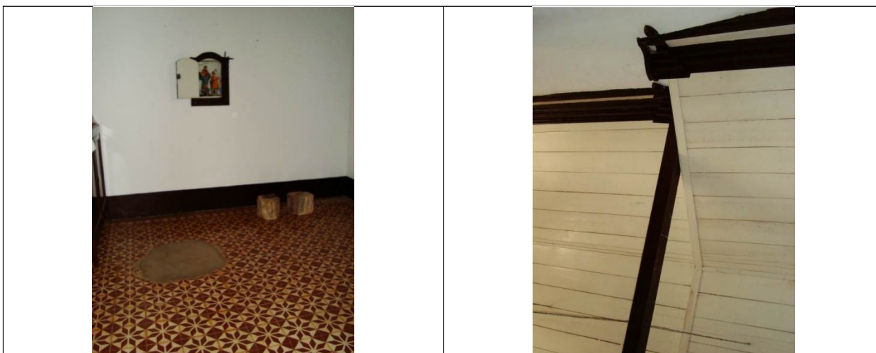
Figura 11 – Piso interno em ladrilho hidráulico com peças faltantes.
