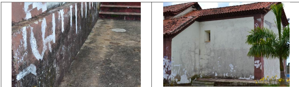
Figura 09 – Presença de fungos junto ao embasamento e ao passeio externo da edificação.
