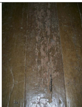
Figura 16 – Cupins no piso.
