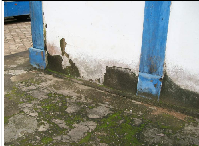
Figura 06 – Pés de esteio substituídos por base de concreto. Verifica-se também a umidade na calçada no entorno do imóvel.
