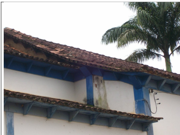
Figura 07 - Infiltração vista pelo lado externo da Capela.
