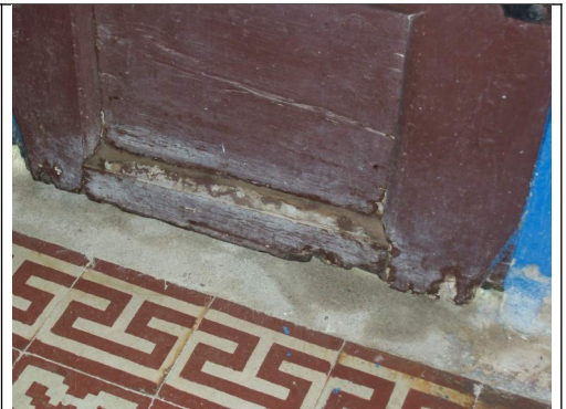
Figura 14 – Cupins nas esquadrias.
