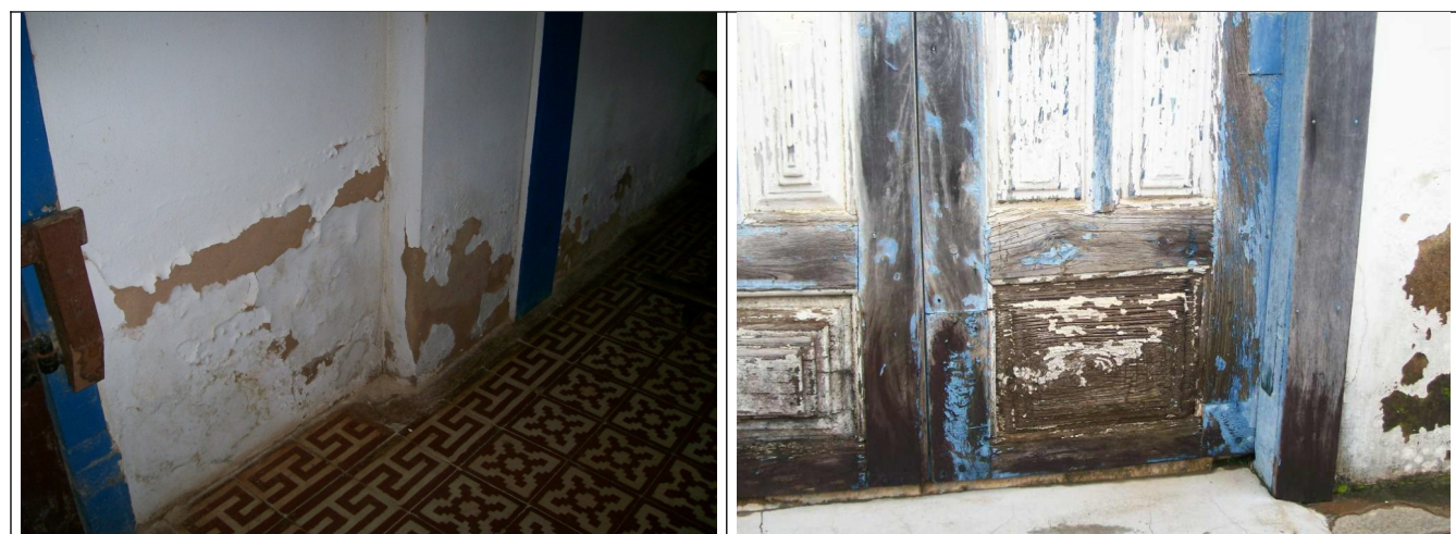
Figura 04 – Umidade nas alvenarias internas da edificação.
