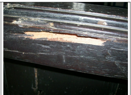
Figura 17 – Cupins no guarda-corpo.
