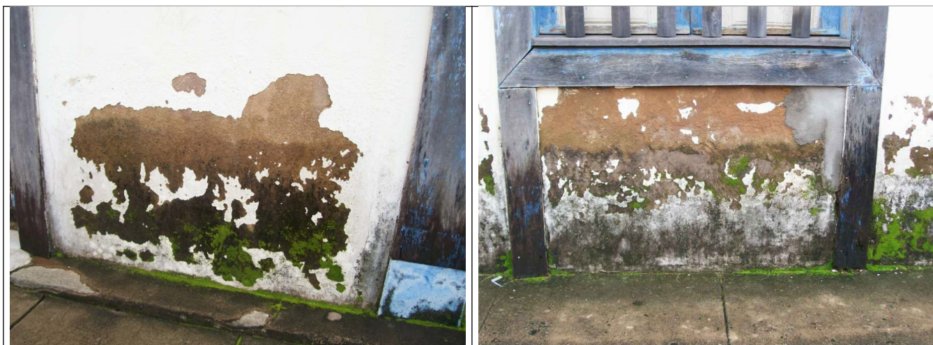
Figuras 03 e 04 – Umidade nas alvenarias externas da edificação.
