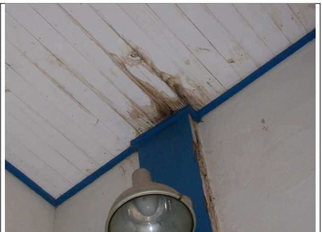
Figura 08 – Infiltração junto a parte elétrica e que está danificando o forro.
