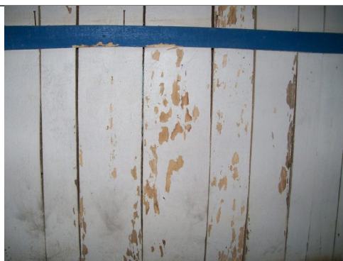
Figura 15 – Cupins na divisória de madeira.
