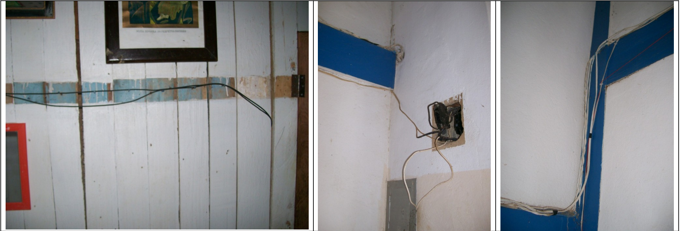
Figuras 09, 10 e 11 - Fiação exposta, sem conduítes, fixadas diretamente na madeira.
