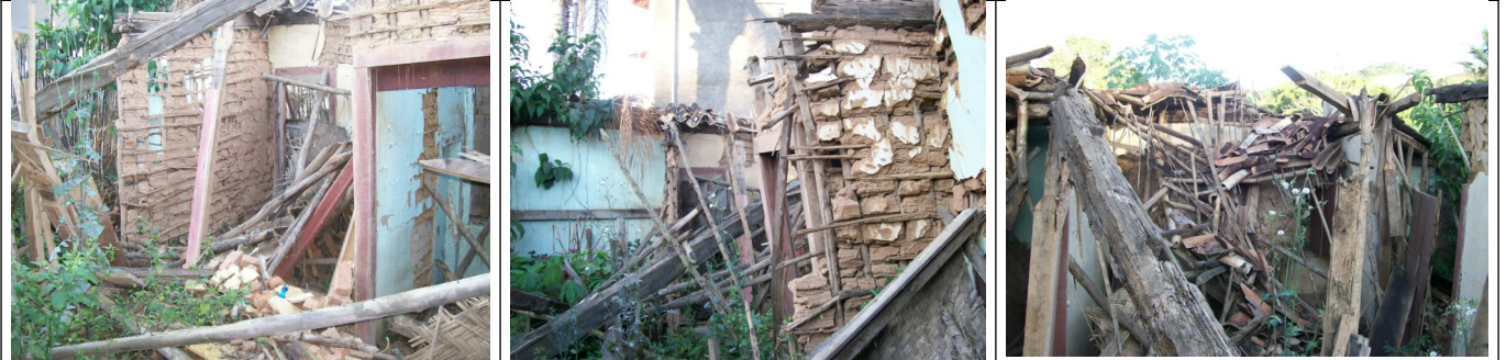
Figuras 14, 15 e 16 – Trechos em ruínas.
