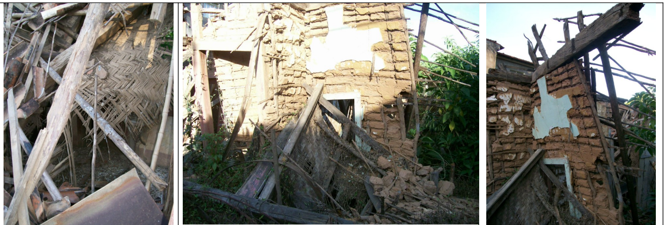
Figura 11 – Telhas, madeira e forro de esteira junto aos entulhos.
