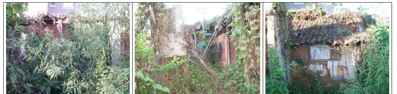
Figuras 23, 24 e 25 - Imagens onde pode-se verificar a grande quantidade de vegetação tomando conta das paredes, da cobertura e do entorno da edificação, contribuindo para o desmoronamento do imóvel
