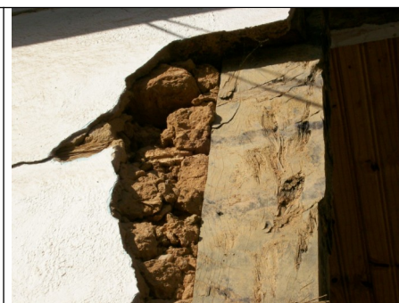
Figura 09 – Estrutura de madeira e alvenaria de pau a pique aparentes, expostas às intempéries..
