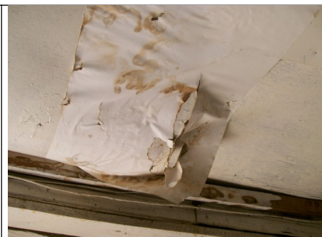
Figura 12 – Sinais de umidade.
