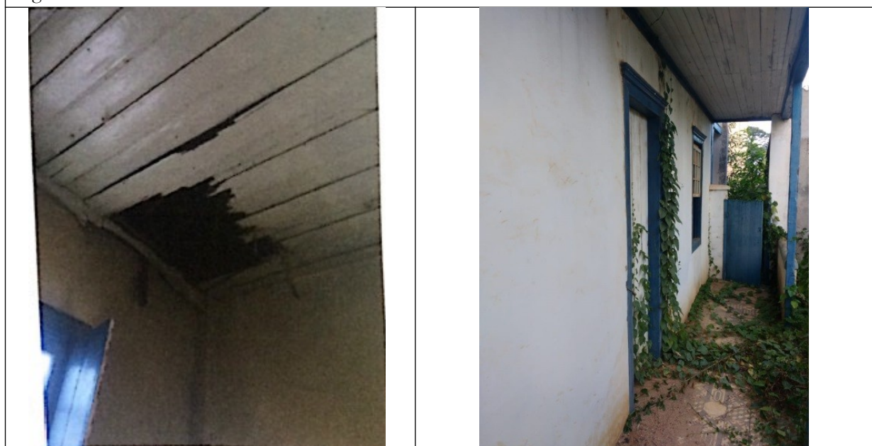
Figura 13 - Comprometimento dos forros.
