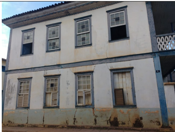
Imagem 02 – Fachada frontal, onde se observam as patologias nas alvenarias e esquadrias.
