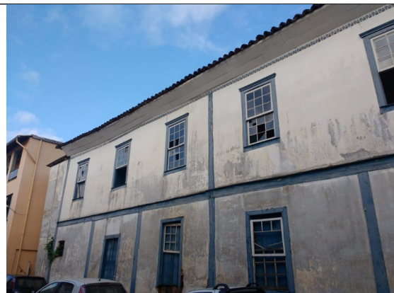
Imagem 03 – Vista fachada lateral esquerda, onde se observam as patologias nas alvenarias e esquadrias.
