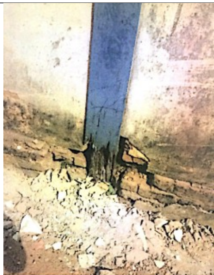
Imagem 09 – Comprometimento do pé de esteio.
