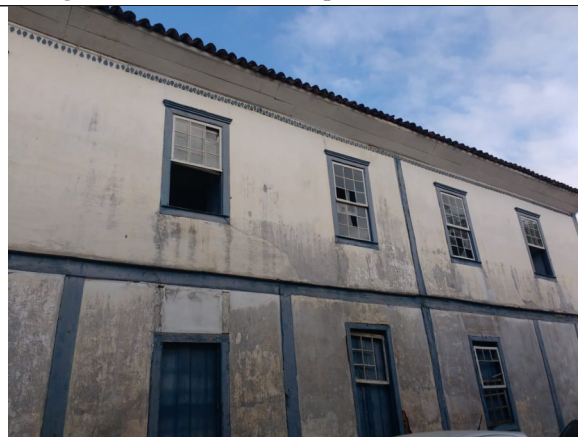
Imagem 04 – Vista fachada posterior, onde se observam as patologias nas alvenarias e esquadrias.
