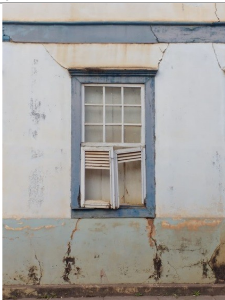
Imagem 07 – Danos nas esquadrias.
