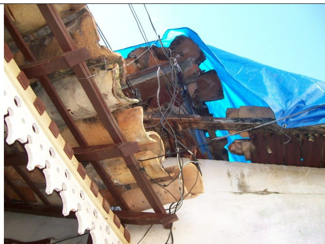
Figura 19 – Fiação elétrica aparente.
