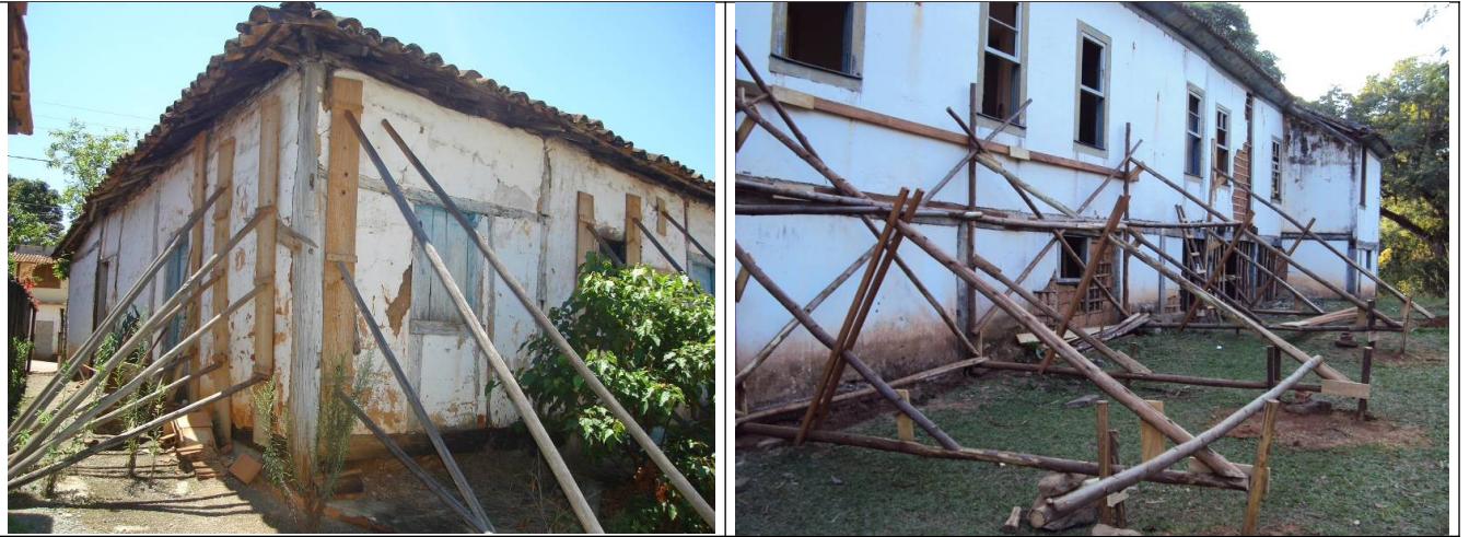
Figuras 05 e 06 – Imagens de escoramentos de fachadas. Fonte : acervo pessoal e do Escritório Técnico do Iphan em São João Del Rei
