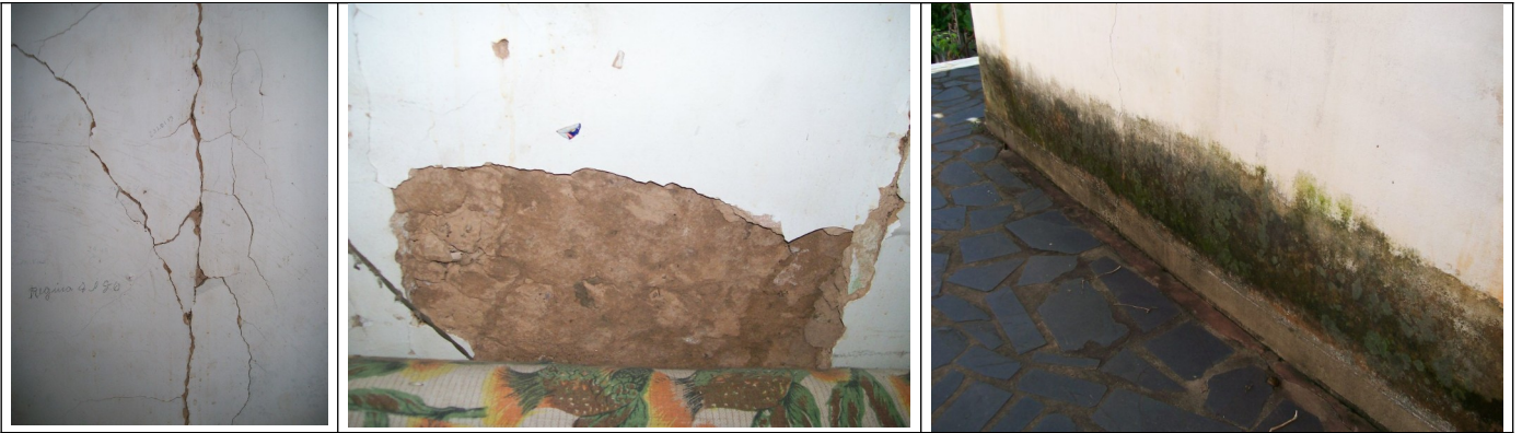
Figuras 11 a 13 – Trincas, descolamento de reboco e manchas de umidade.
