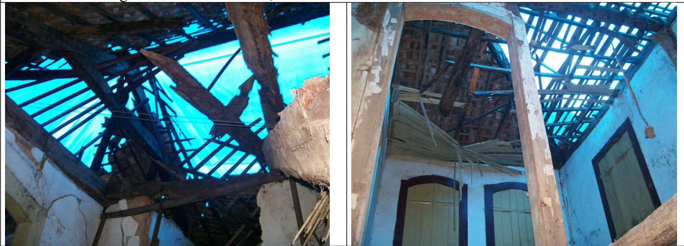
Figuras 14 e 15 – Trechos em arruinamento.
