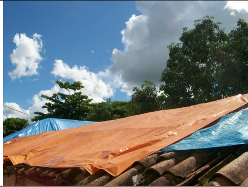
Figura 22 – Lona solta sobre cobertura.
