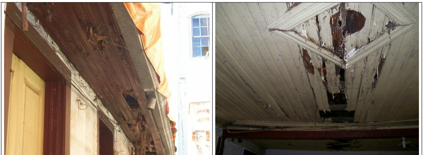
Figuras 16 e 17 – Guarda pó e forros de madeira comprometidos.
