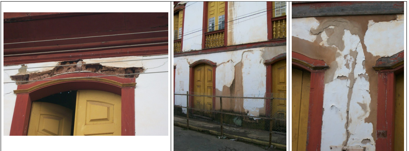
Figuras 10 a 12 – Trincas, descolamento de reboco e manchas de umidade.
