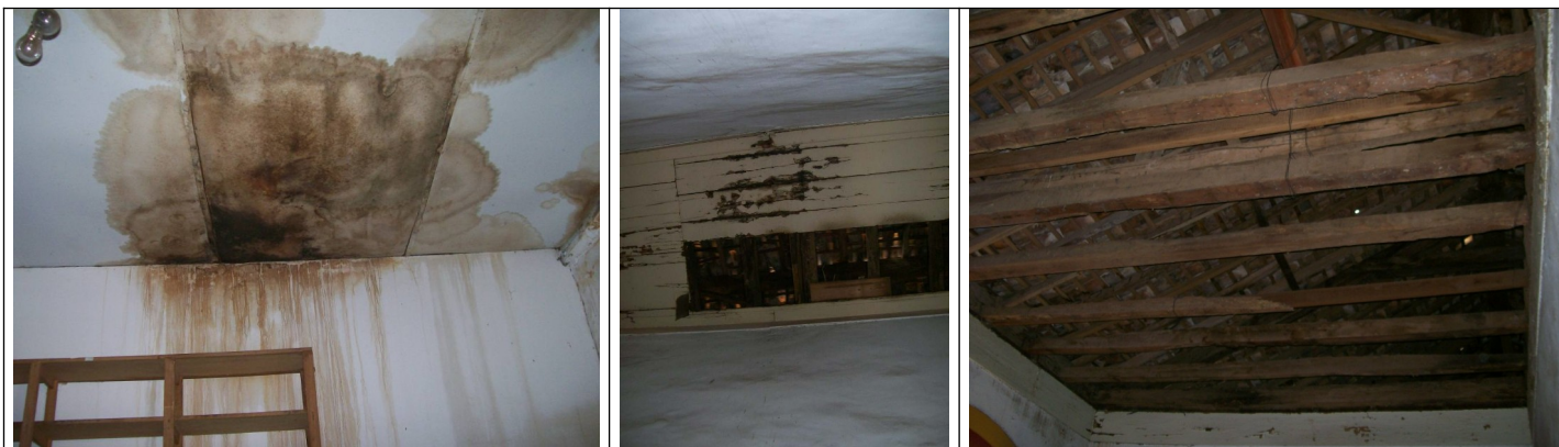
Figuras 15 e 16 – Forros danificados
