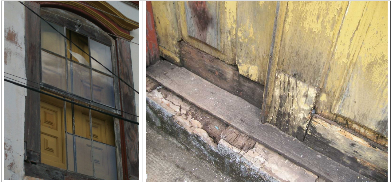
Figuras 08 e 09 – Esquadrias danificadas.
