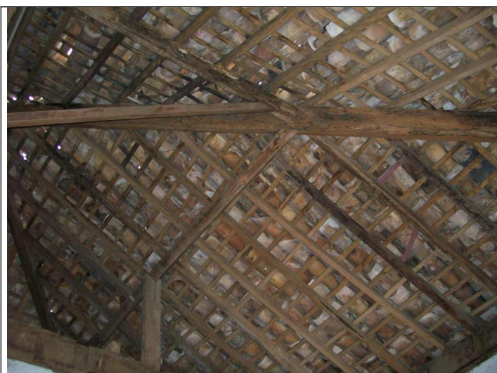
Figura 18 – Trechos da cobertura em podemos visualizar locais onde é possível a entrada de água..
