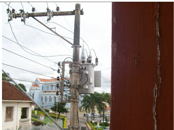
Figura 29 – Transformador junto à edificação.
