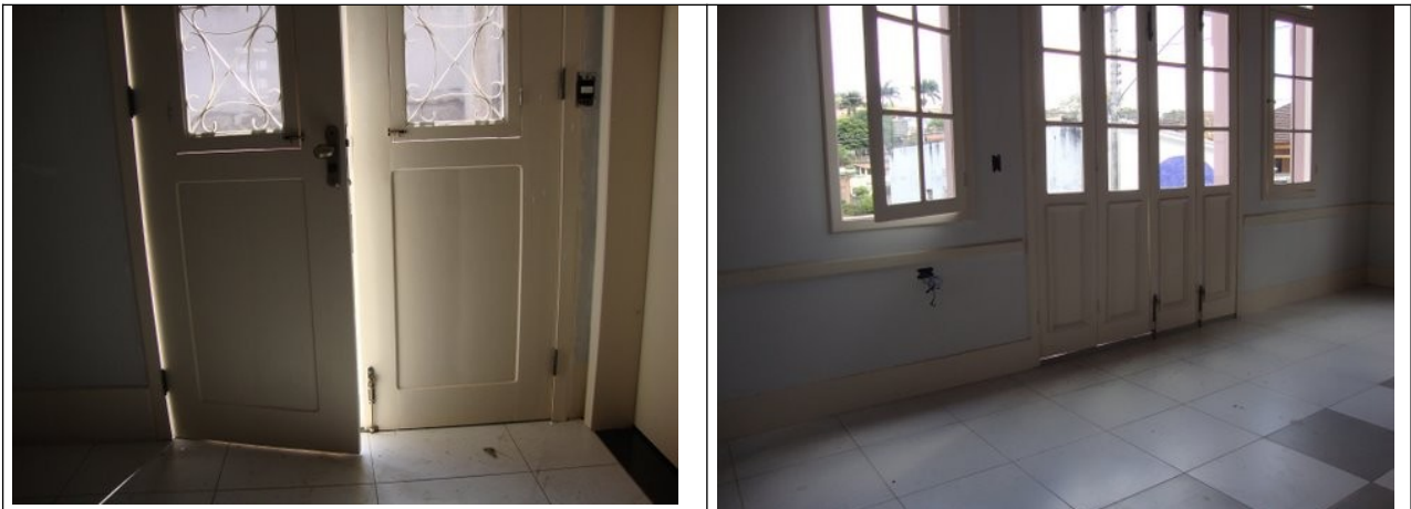
Figuras 05 e 06 – Portas originais (de acesso ao segundo pavimento e de acesso à sacada) que seriam comprometidas em sua integridade com a elevação do piso.
