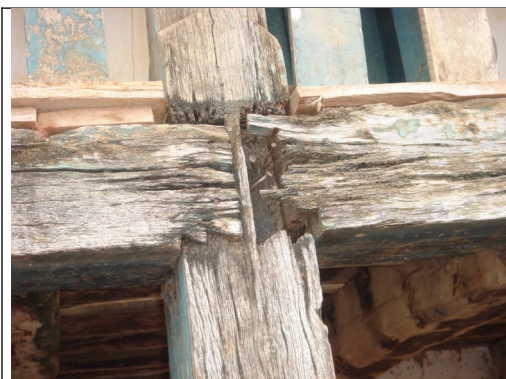
Figura 15 – Madeira estrutural desgastada.
