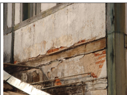
Figura 18 – Manchas de umidade e descolamento de reboco na fachada.
