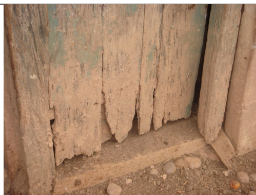
Figura 16 – Folha de madeira da porta desgastada.
