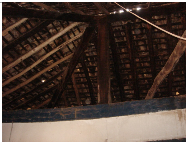
Figura 11 – Ausência de forro – telha vã.
