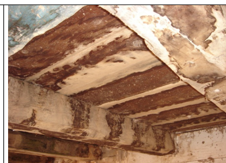
Figura 20 – Manchas de umidade no piso e barroteis.
