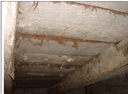
Figura 12 – Forro com barrotes e tábuas corridas do piso superior.
