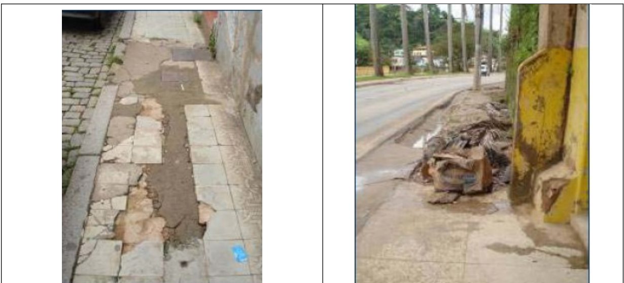
Figura 21- Imagem de um passeio danificado no centro de Ponte Nova. Fonte: Dossiê de Tombamento do Núcleo Histórico de Ponte Nova.
