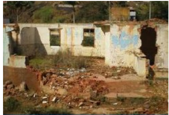
Figura 24- Imagem mostrando a degradação na Vila Alvarenga. Fonte: Documentação fotográfica acostada aos autos
