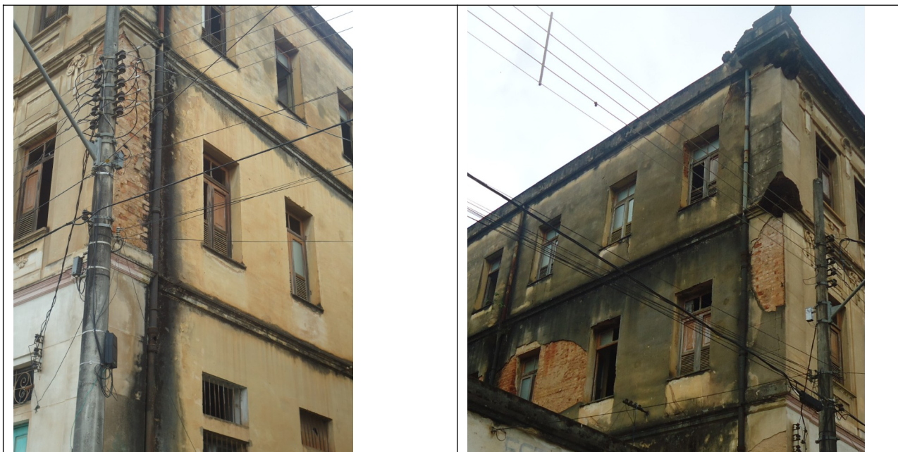
Figuras 15 e 16 – Manchas de umidade e descolamento do reboco.
