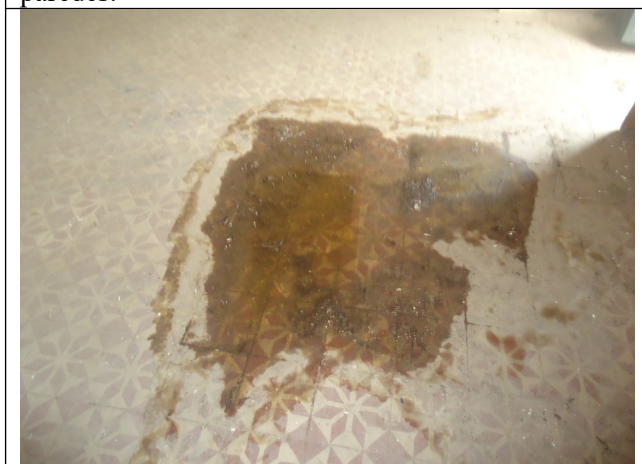
Figura 21 – Poça de água no interior da edificação.
