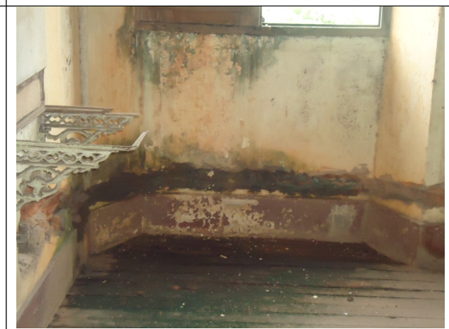
Figura 22 – Danos no piso e nas alvenarias causadas pela presença de umidade.
