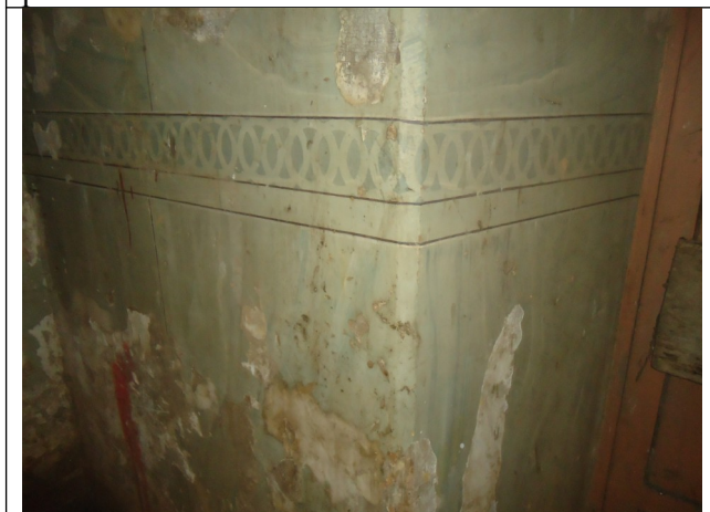
Figura 19 – Danos nos elementos decorativos das paredes.
