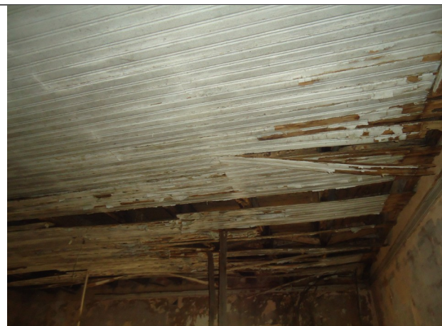
Figura 26 – Danos no forro causados pela presença de umidade.
