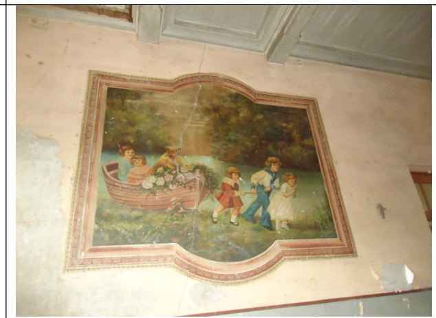
Figura 20 – Trinca sobre pintura decorativa.
