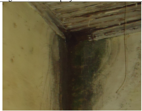
Figura 30 - Danos no forro e nas alvenarias causados pela presença de umidade.
