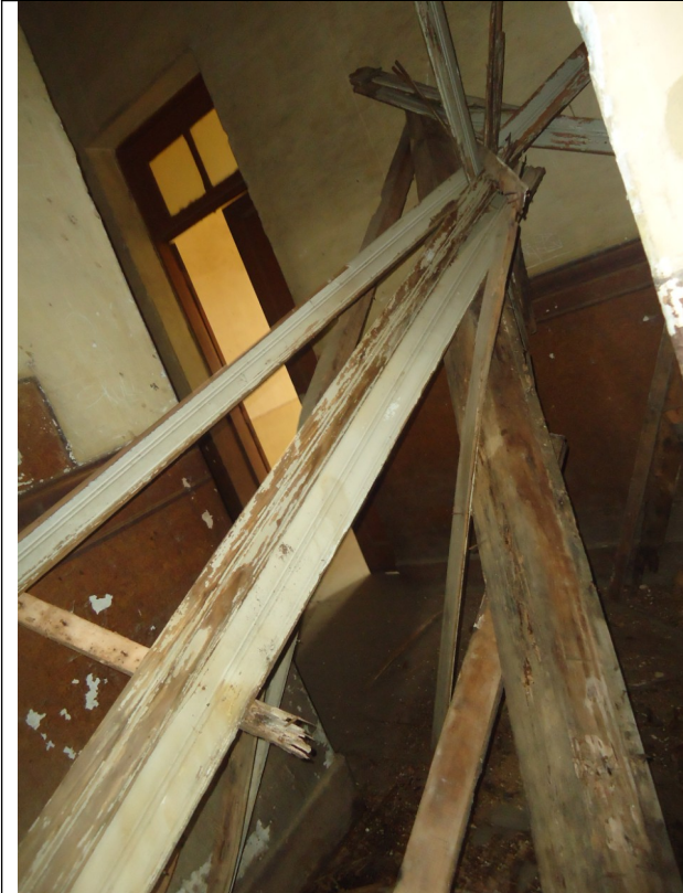
Figura 23 – Arruinamento de parte do forro e da cobertura.
