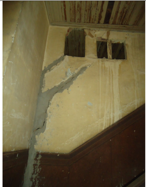
Figura 28 – Trinca que já foi selada e voltou a abrir.
