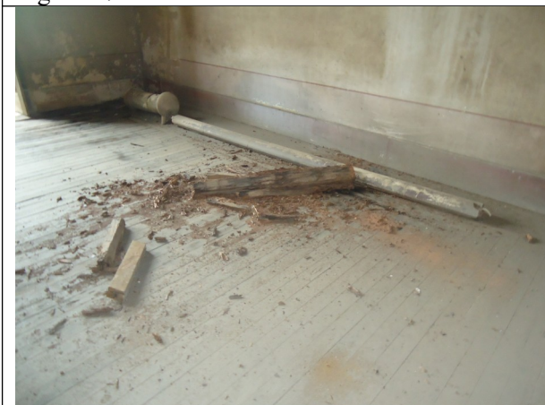
Figura 29 – Trechos da cobertura e do forro que se desprenderam.
