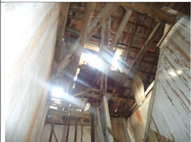
Figura 25 – Trecho arruinado da cobertura e do forro.
