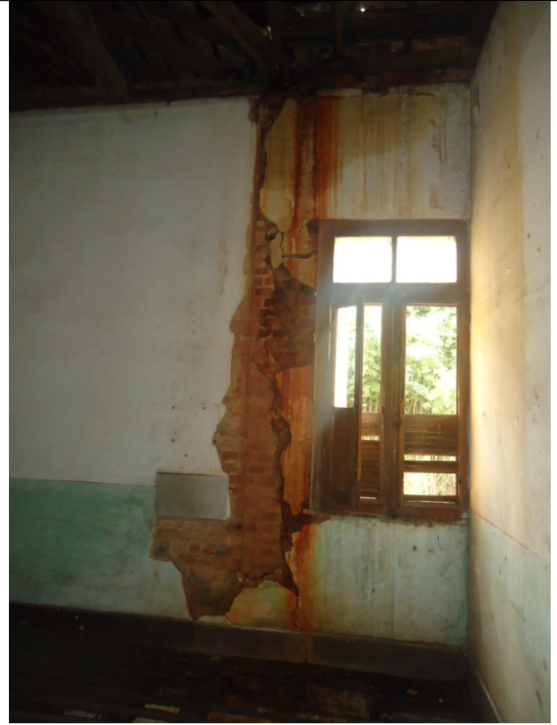
Figura 24 – Grande trinca, descolamento do reboco e manchas de umidade.
