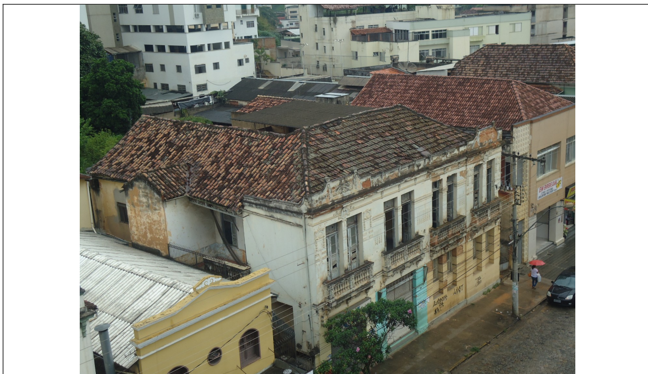
Figura 08 – Vista da cobertura da edificação, que apresenta abatimentos e telhas danificadas.
