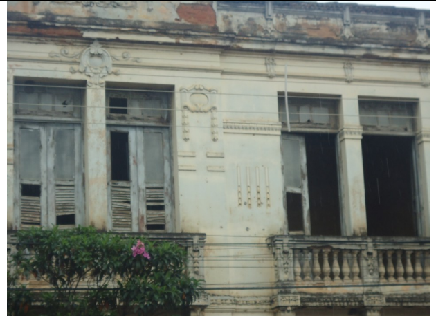
Figura 10 – Esquadrias danificadas que permanecem abertas, expondo o imóvel às intempéries.
