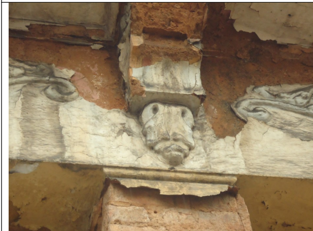
Figura 11 – Descolamento dos ornamentos em massa.
