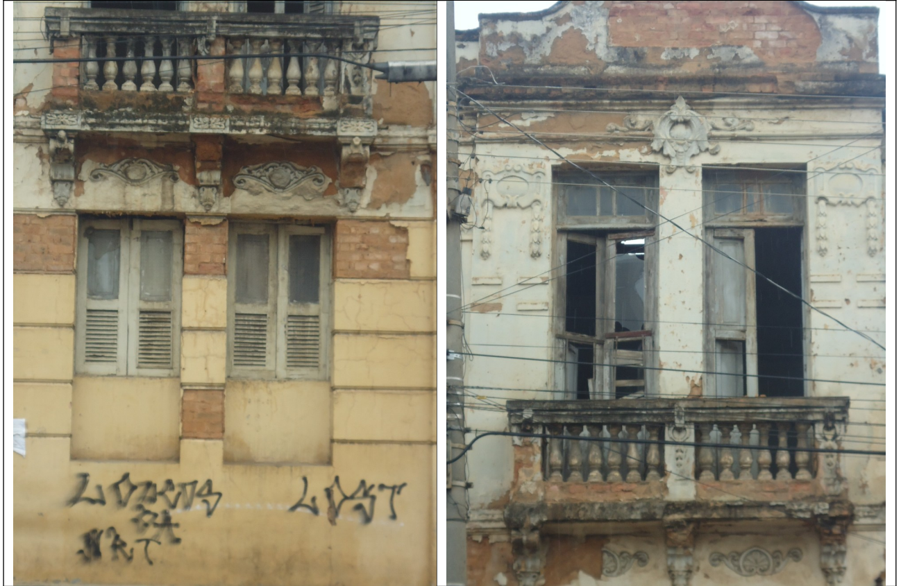
Figuras 15 e 16 – Descolamento de reboco e dos ornamentos em massa, danos nas esquadrias e pichações nas alvenarias.
