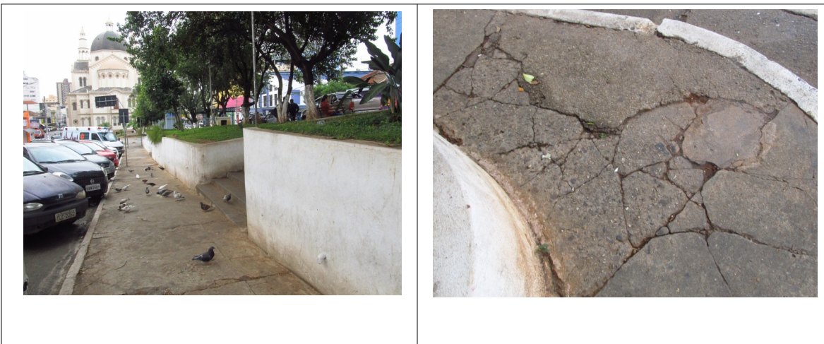
Figuras 16 e 17- Praça Dr. Garcia Coutinho, onde se verifica a presença de trincas na pavimentação.
