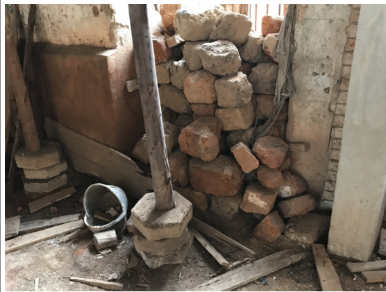
Figura 08 - Escoramento precário e restos de adobe no local.
