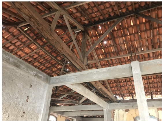
Figura 13 - Engradamento da cobertura recuperado, com presença de lacunas devido ao deslocamento das telhas.
