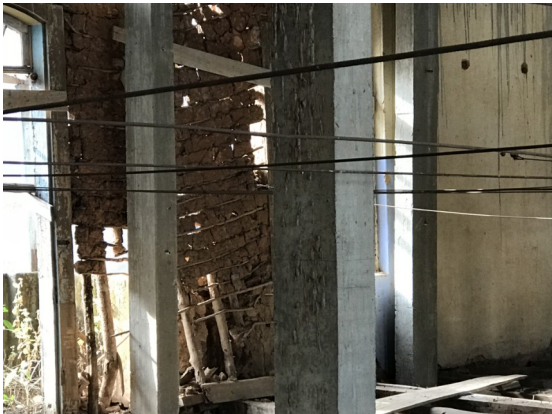
Figura 04 - Arruinamento de parede externa em pau a pique.
