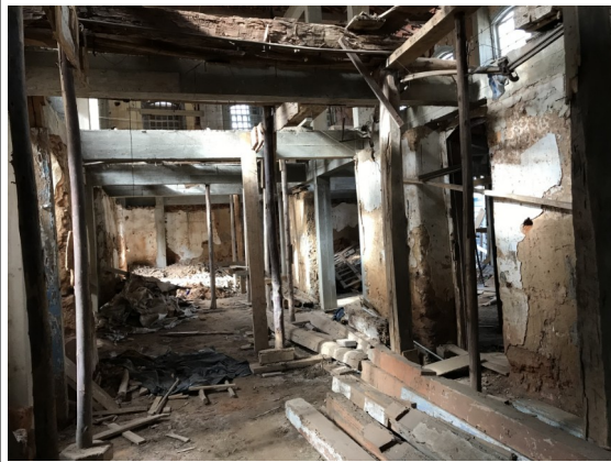
Figura 10 - Aspecto interno do imóvel onde nota-se a execução de estrutura em concreto armado e a existência de muito entulho no interior da edificação.
