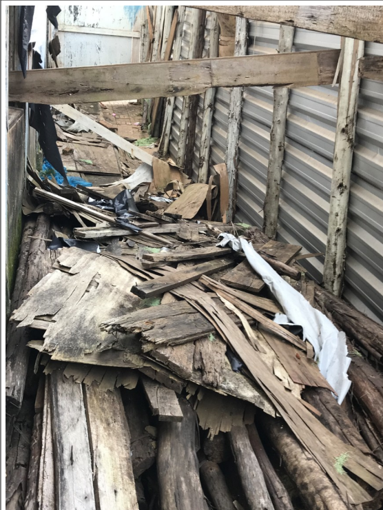
Figura 14 - Presença de muito entulho na área entre a edificação e o tapume.
