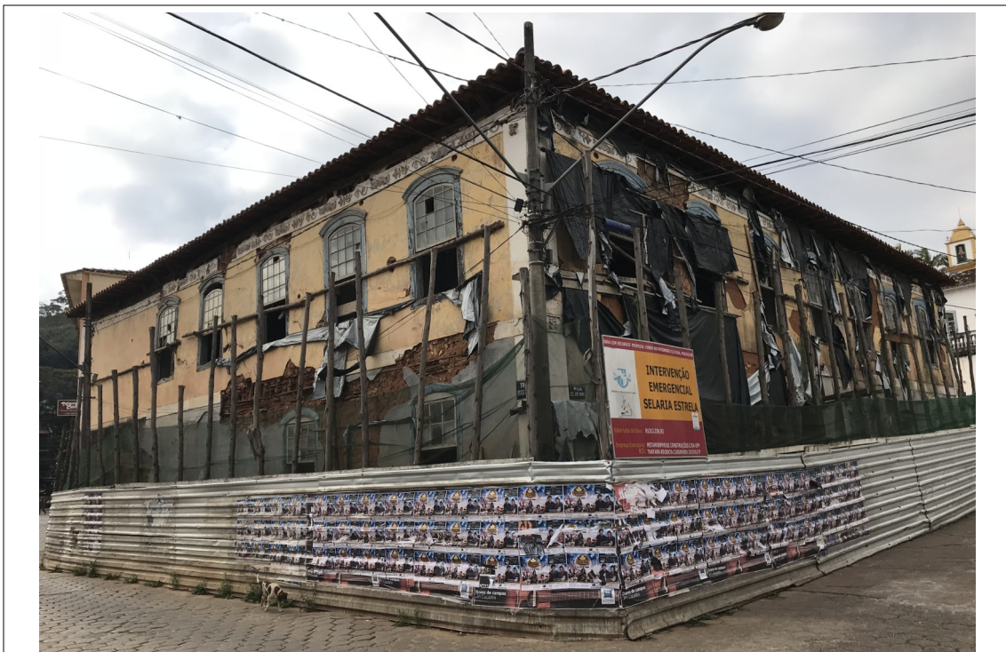
Figura 01 - Fachadas da Selaria Estrela com restos de lona, escoramento, desprendimento de reboco e tapume com cartazes fixados.
