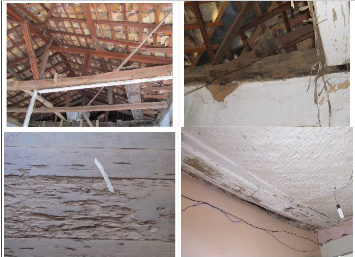
Figura 14, 15, 16 e 17- Imagens internas do prédio da Antiga Prefeitura de Presidente Bernardes, destacando trecho da cobertura, do assoalho e do forro. Fotos da vistoria realizada em 28/06/2012.
