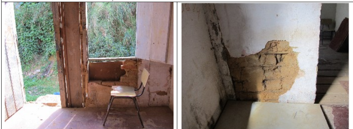
Figura 18 e 19- Imagens internas das condições das paredes do prédio da Antiga Prefeitura de Presidente Bernardes. Fotos da vistoria realizada em 28/06/2012.
