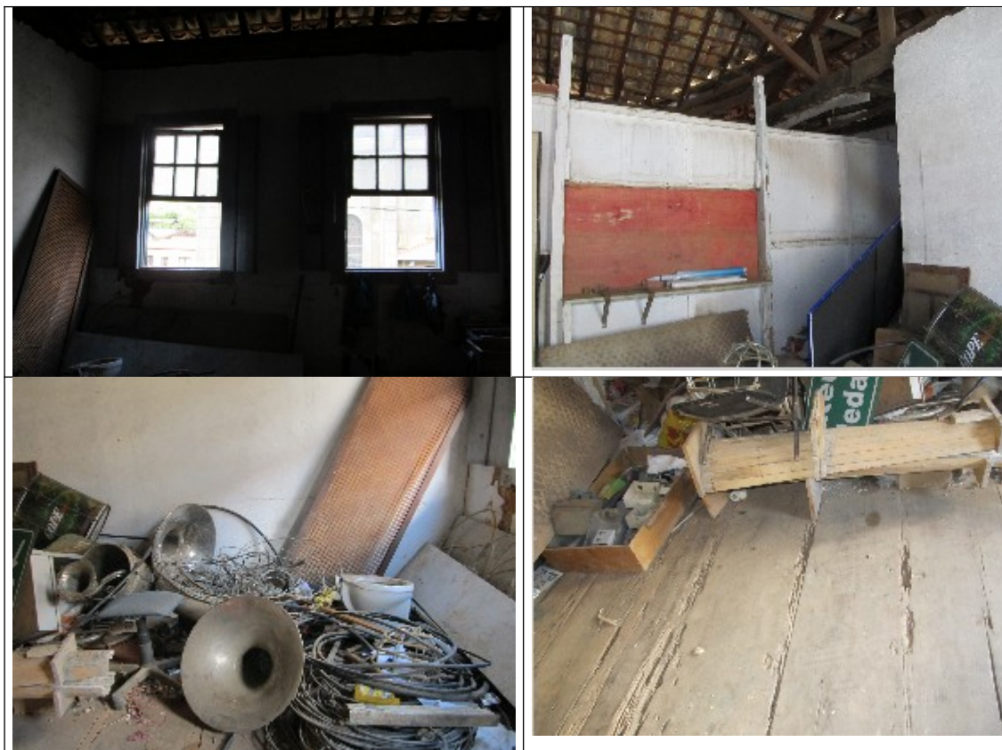
Figuras 20, 21, 22 e 23- Sala do 2º pavimento do prédio da Antiga Prefeitura de Presidente Bernardes, utilizada como depósito. Fotos da vistoria realizada em 28/06/2012.
