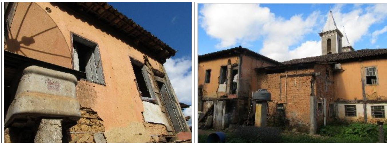
Figuras 10 e 11 – Acréscimos e descolamento do reboco da fachada dos fundos.
