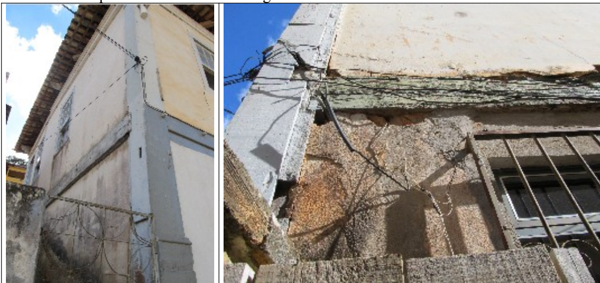
Figura 8 e 9- Imagens da fachada lateral direita e de trecho da fachada lateral esquerda do casarão da antiga Prefeitura de Presidente Bernardes, com fiação exposta. Fotos da vistoria realizada em 28/06/2012
