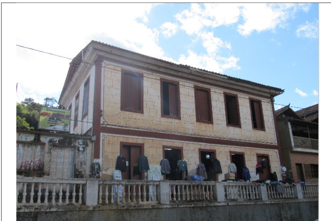
Figura 13 – Imagem externas do casarão de João Soares Vidigal. Fotos da vistoria realizada em 28/06/2012.
