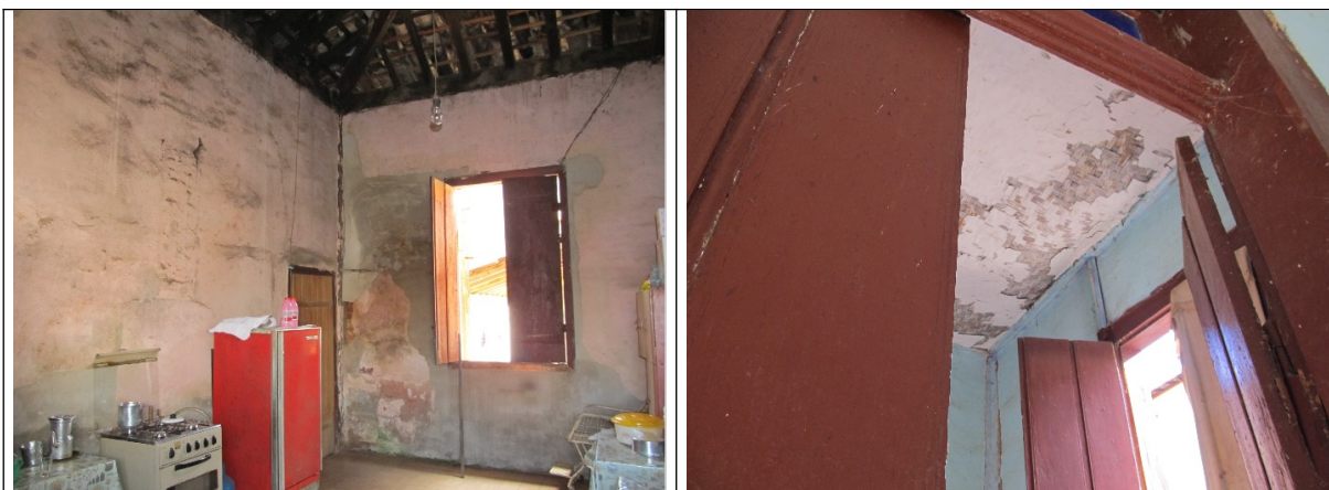
Figura 18 e 19- Imagens internas do casarão de João Soares Vidigal, destacando as condições de suas paredes e forros. Fotos da vistoria realizada em 28/06/2012.
