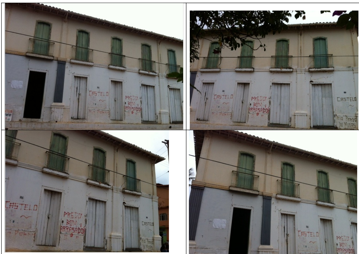
Figura 7, 8, 9 e 10- Imagem do Sobrado João Mendes em Rio Pardo de Minas. Fonte: Documentação fotográfica acostada aos autos.
