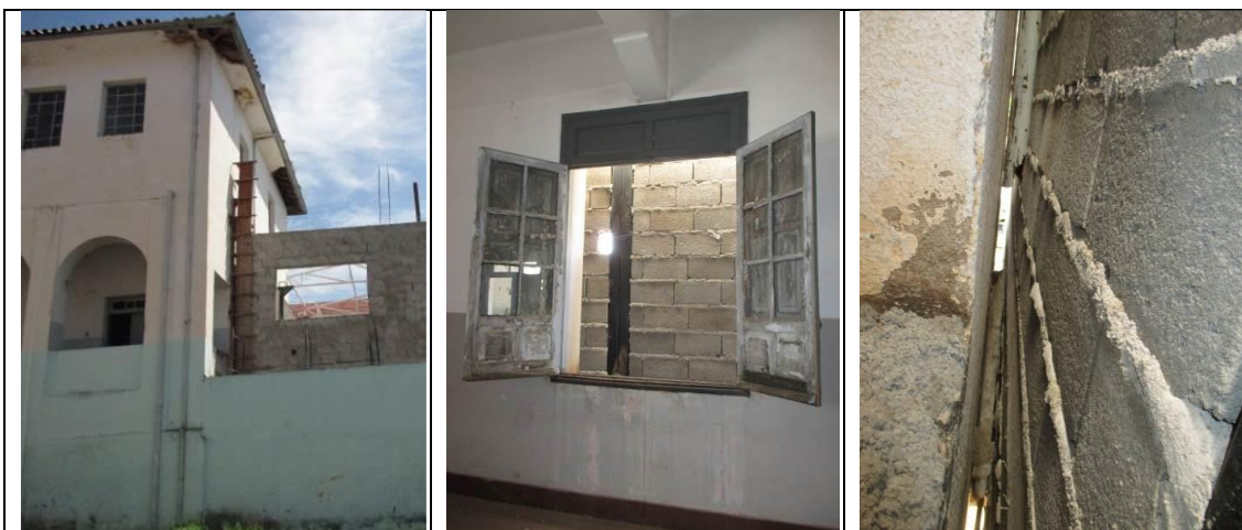
Figuras 02 a 04 – Imagens da nova construção junto com as alvenarias da edificação tombada. Fonte: Laudo do estado de conservação do Instituto Monsenhor Felipe, outubro de 2016.
